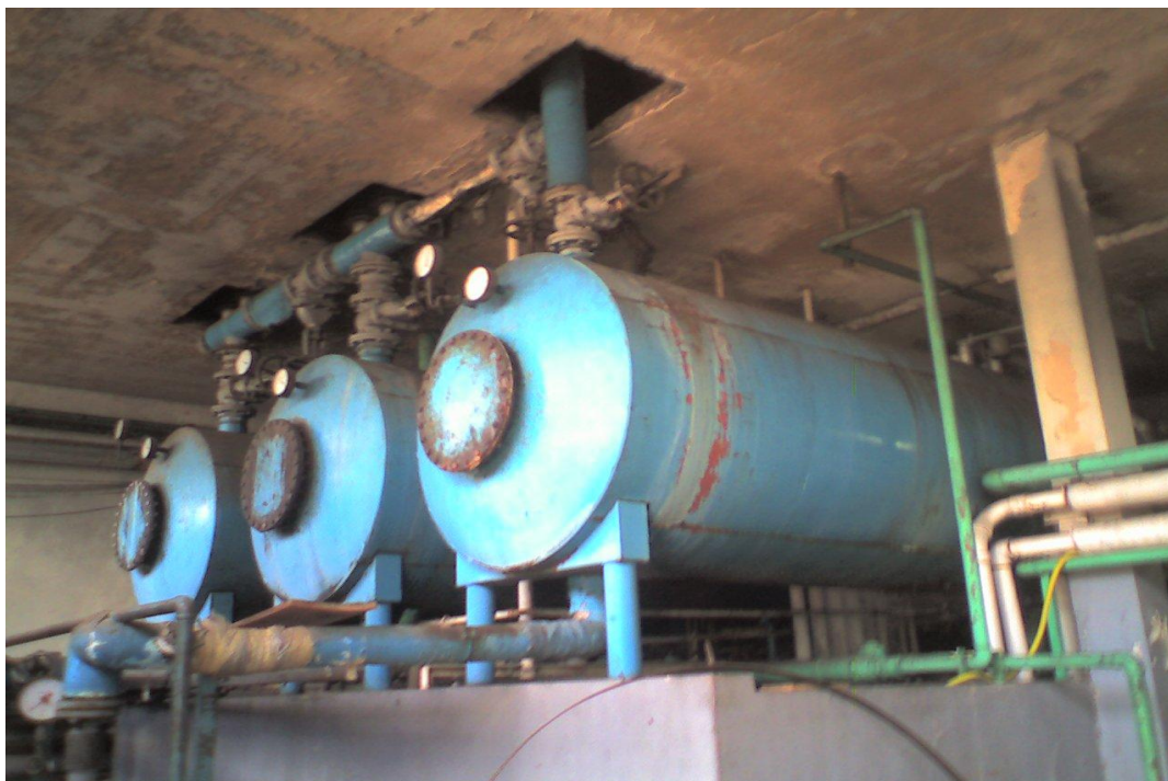
FIGURA 30 Três boilers de fornecimento de água quente hospital.
