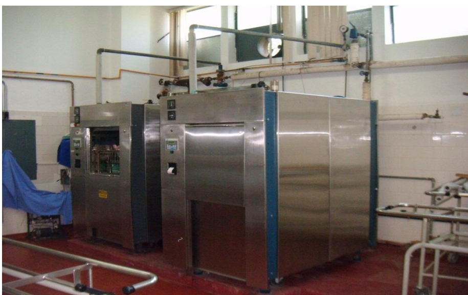
FIGURA 45 Autoclaves do hospital.
