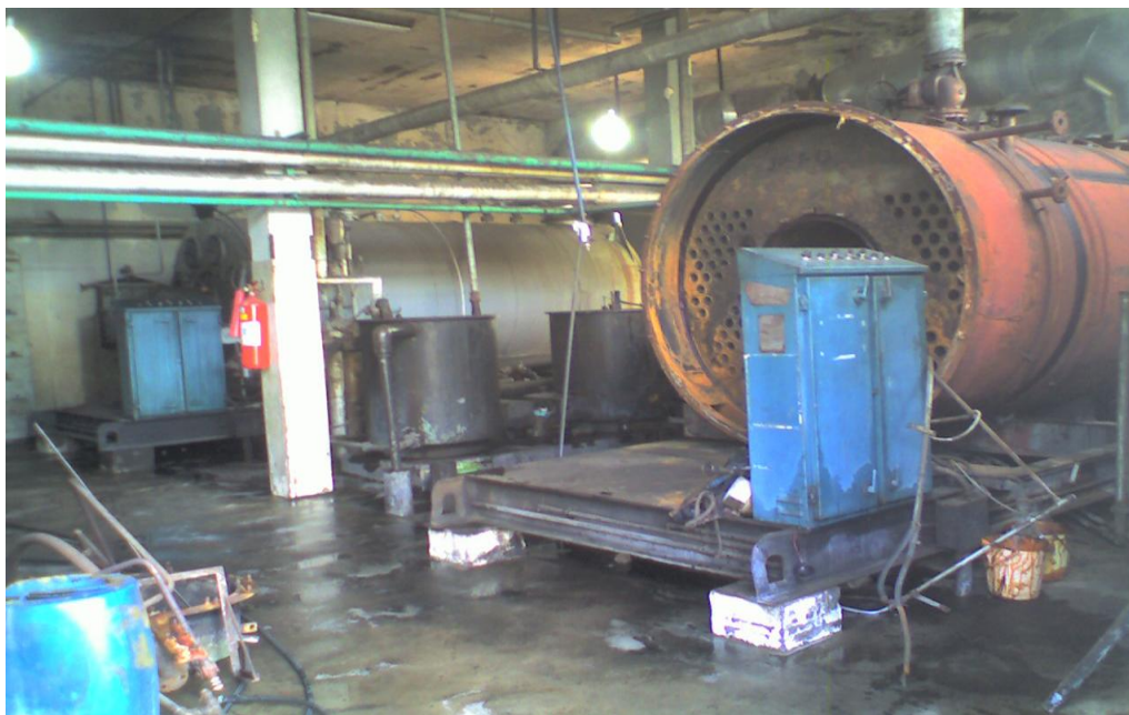
FIGURA 29 Área da caldeira, com uma em manutenção.
