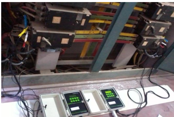
FIGURA 20 Medição de curvas de cargas QGBT -SUBESTAÇÃO SE. (A1b)
