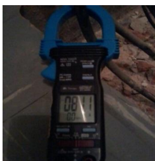
FIGURA 21 Medição wattímetro QGBT-SUBESTAÇÃO SE. (A1b)
