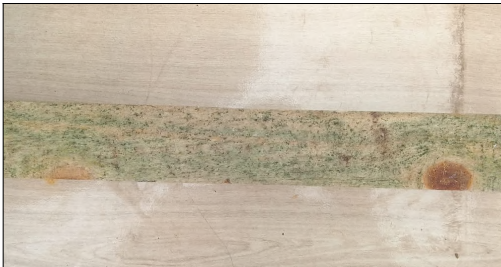
Figura 34 - Fungo cromógeno em peça estrutural de Pinus elliottii
