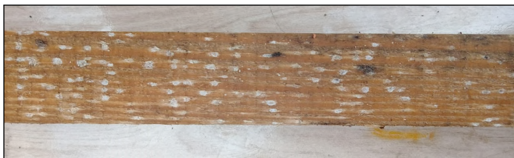
Figura 35 - Fungo apodrecedor em peça estrutural de Pinus elliottii
