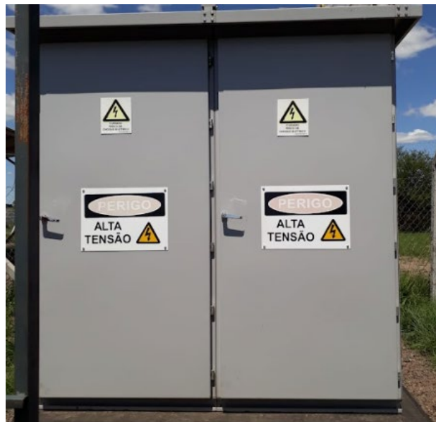
Figura 10 - Conjunto blindado devidamente sinalizado.
