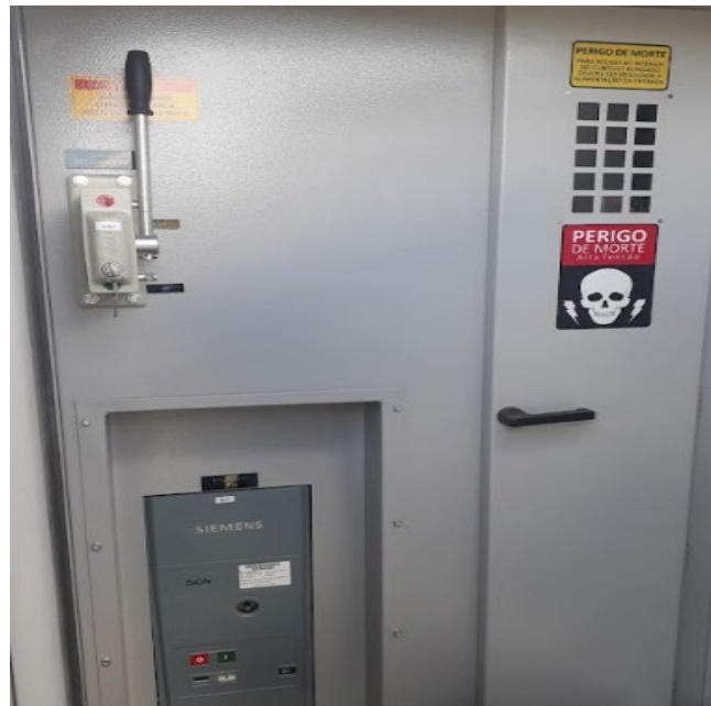
Figura 5 - Cubo blindado da medição com a chave seccionadora e disjuntor.
