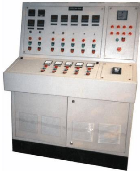
Figura 18 - Painel elétrico do tipo mesa
