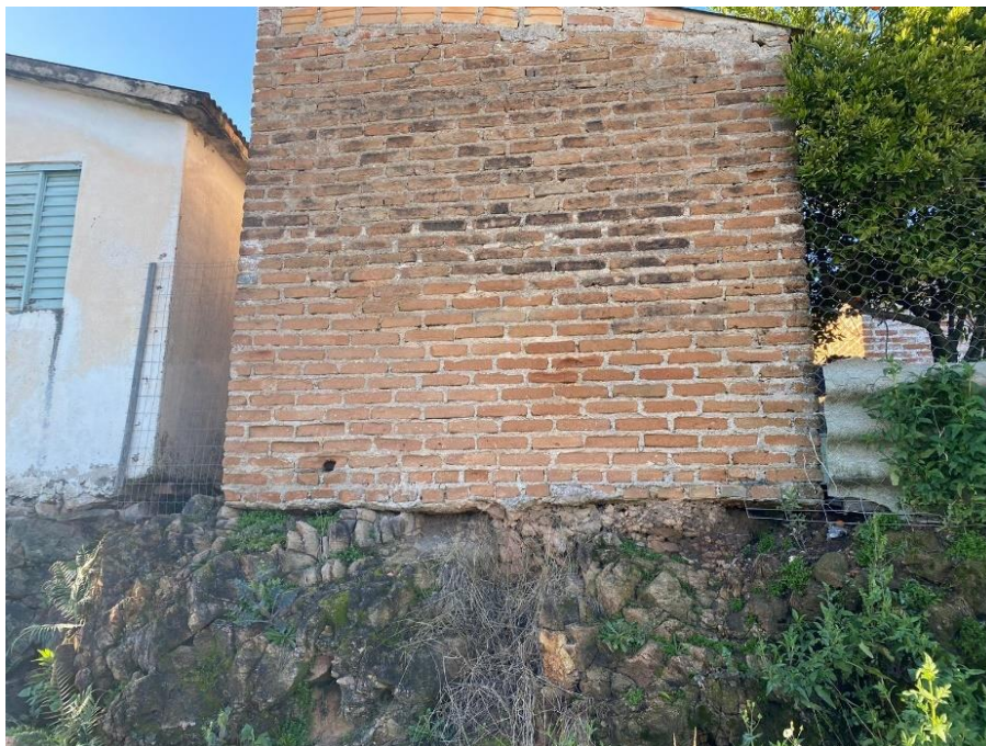
Figura 17: Casa em possível local de risco a deslizamentos.
