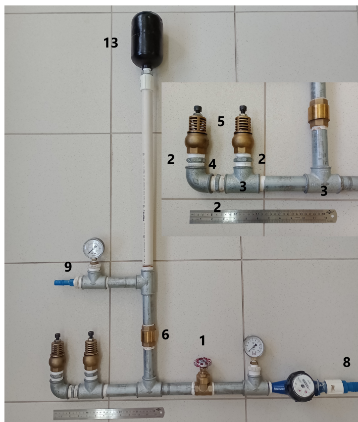
Figura 8 – Carneiro hidráulico montado
