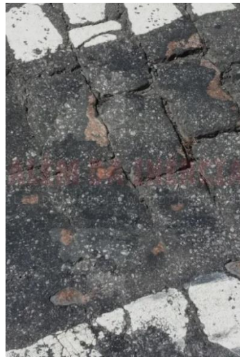
Figura 8 - Pavimento degradado em estágio avançado de reflexão de trincas
