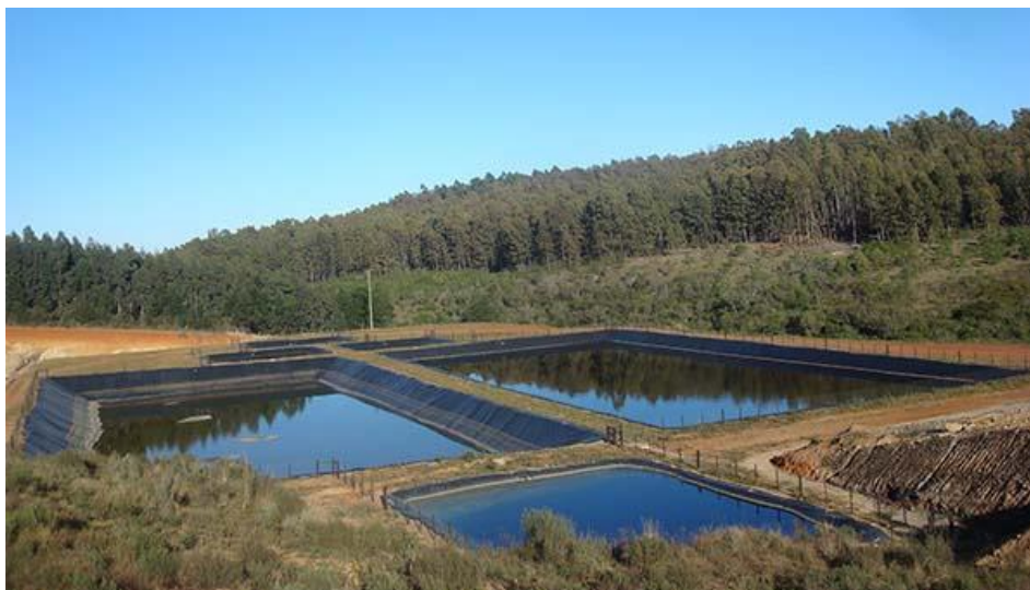
Figura 15 - Tratamento de Percolado em Aterro Sanitário
