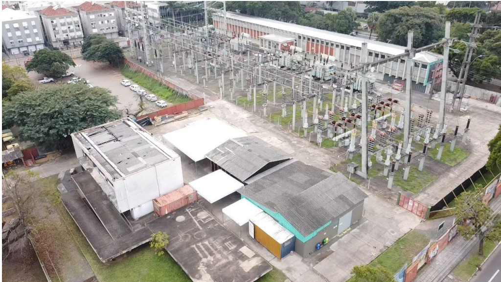
Figura 4.1 – Subestação Porto Alegre 4 230/13,8 kV.
