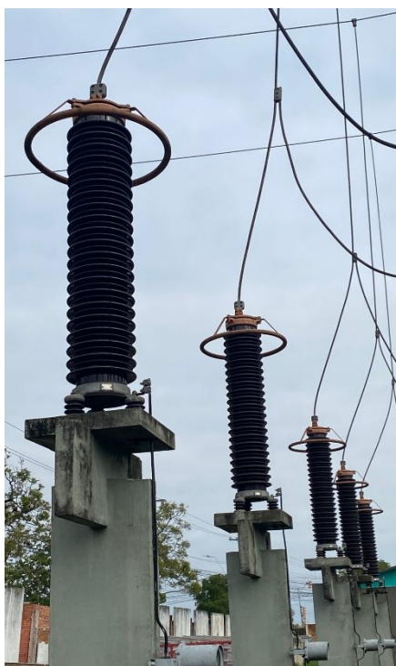
Figura 2.6 – Para-raios SE PAL4 pátio 230 kV.
