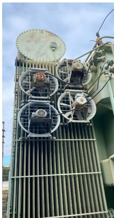
Figura 2.12 – Moto-ventilação para refrigeração forçada do óleo do TR SE PAL4.
