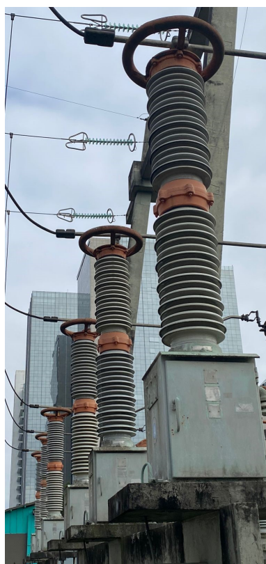
Figura 2.14 – Transformador de potencial tipo pedestal SE PAL4.
