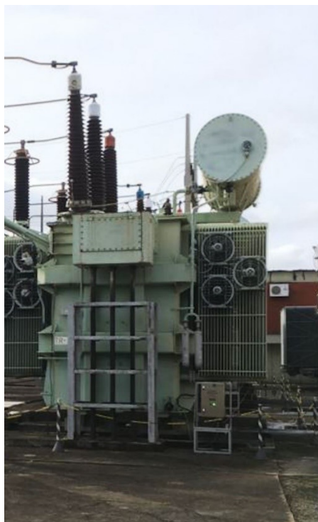
Figura 2.7 – Transformadores de força atual 230/13,8 kV.
