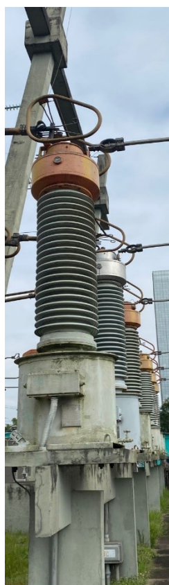
Figura 2.13 – Transformador de corrente tipo pedestal SE PAL4.
