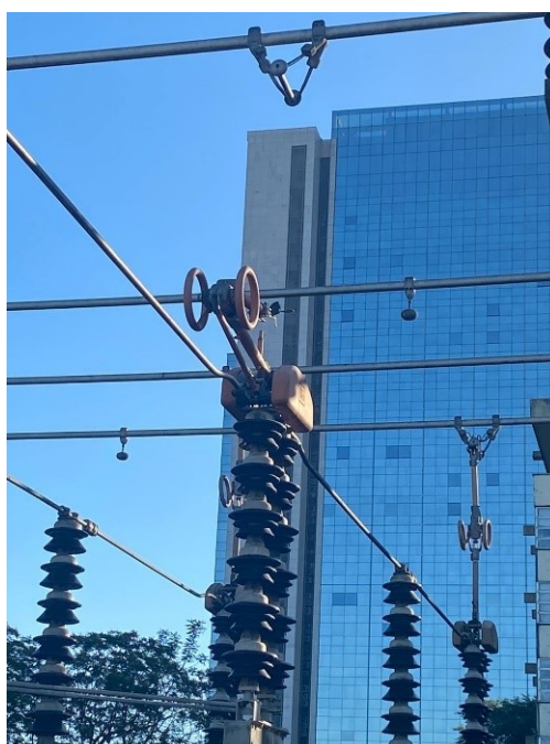
Figura 2.5 – Chaves Seccionadores SE PAL4 pátio 230 kV.
