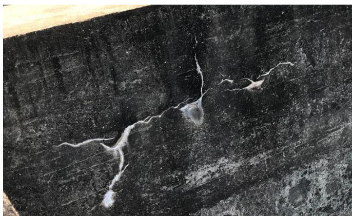
Figura 15 - Eflorescência sobre concreto
