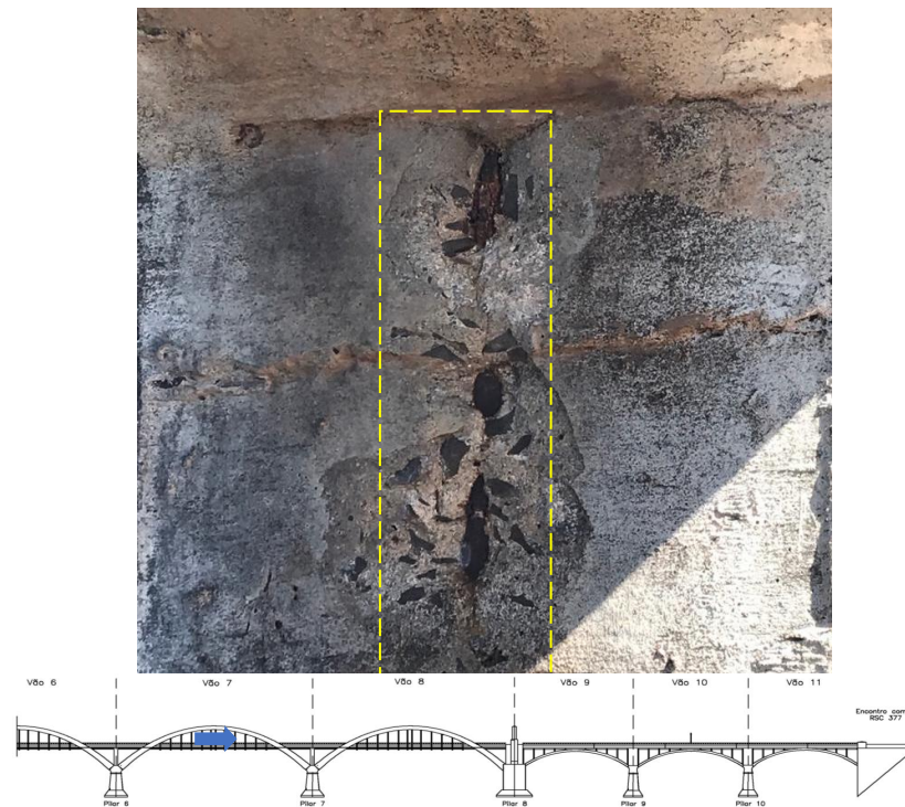
Figura 31 – Armadura Exposta Pendural 9 do Arco Superior do Vão 7
