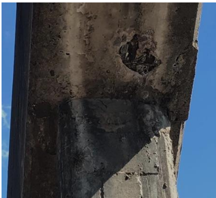
Figura 12 - Armadura exposta, apresentando corrosão.
