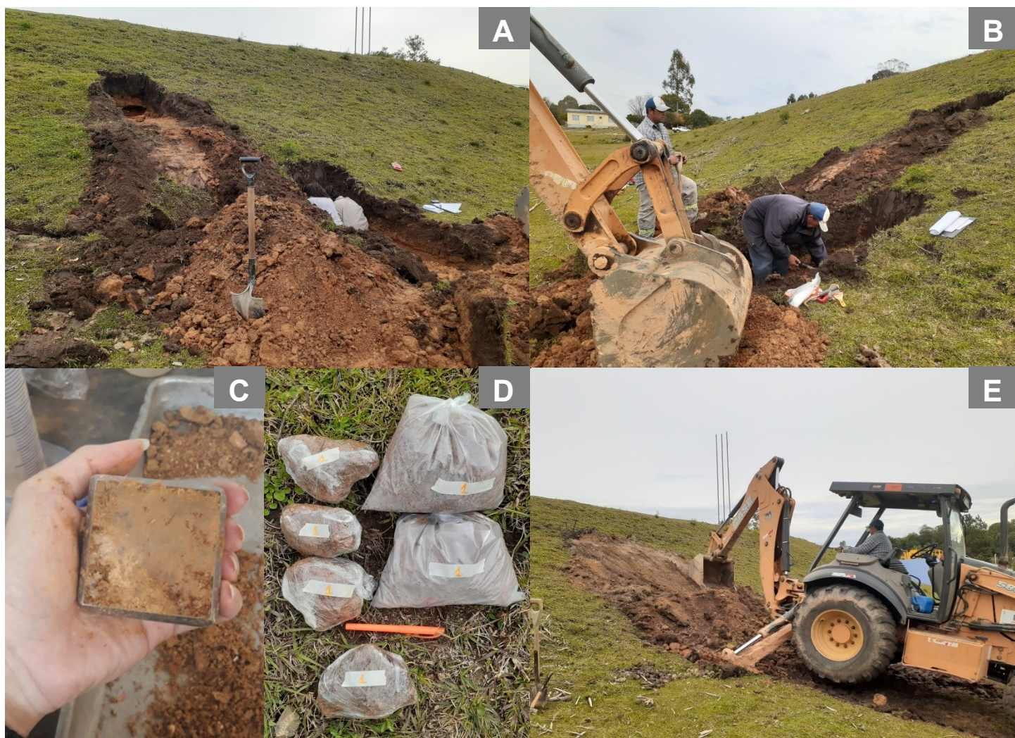
Figura 31. (A) cavas realizadas a jusante do talude; (B) equipe de apoio de campo; (C) material cravado no anel de cisalhamento; (D) armazenamento e identificação das amostras; (E) cavas recobertas com o mesmo material.
