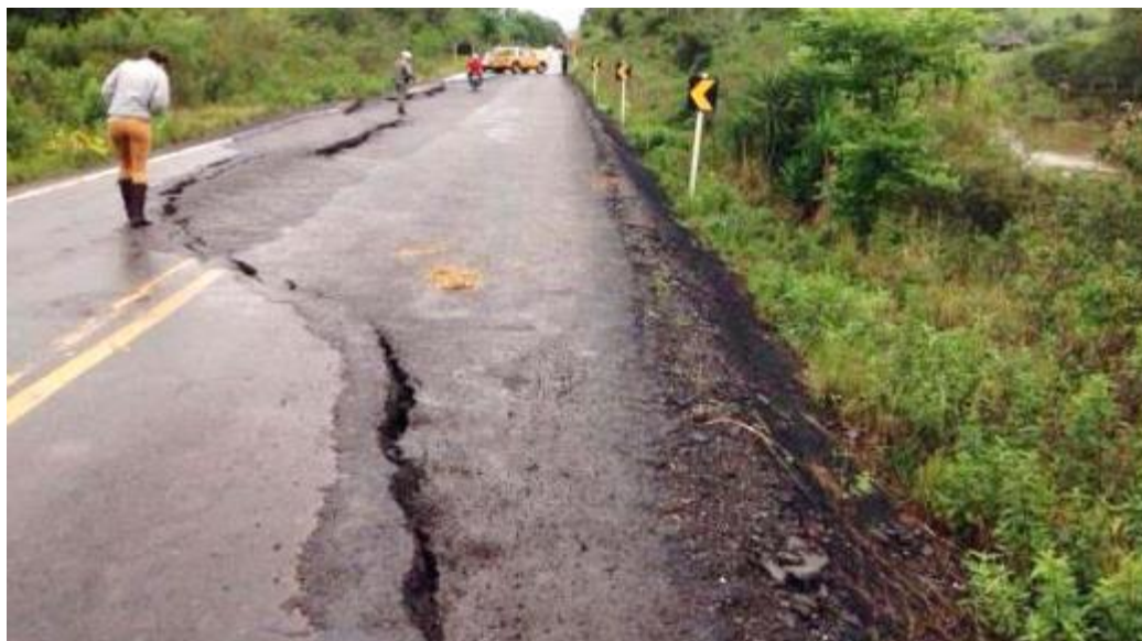
Figura 14- Ruptura do asfalto em 2015.
