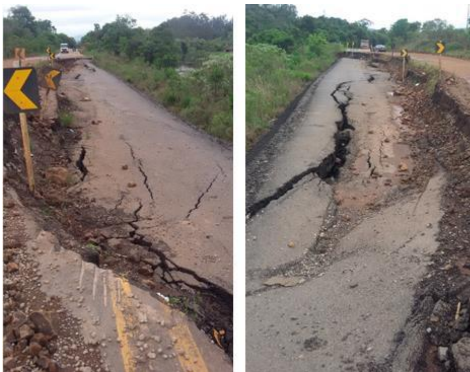
Figura 15- Foto da rodovia no ano seguinte ao deslizamento, 2016.
