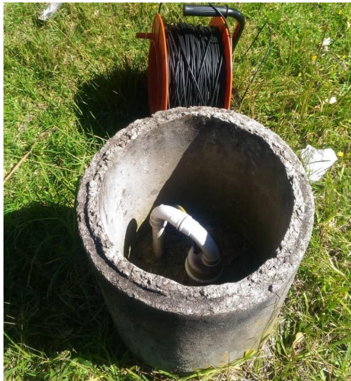
Figura 20: Poço tubular em utilização.
