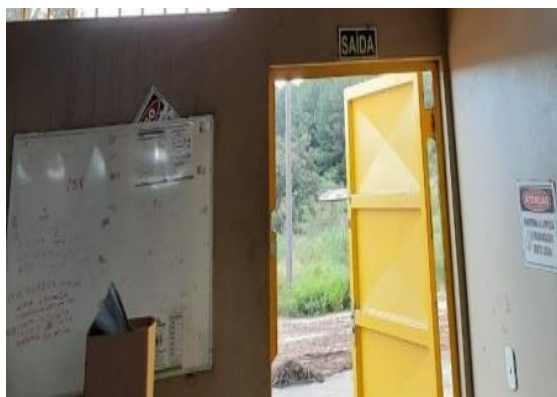
Figura 26– Placas sinalizadoras internas do local de armazenamento de agrotóxicos.
