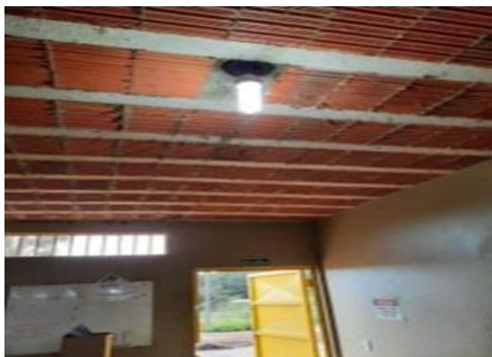
Figura 21– Iluminação artificial no interior do local de armazenamento de agrotóxicos.
