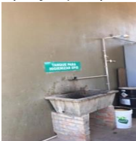
Figura 27 – Torneira externa para higienização com placa sinalizadora.
