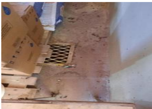
Figura 10 – Sistema de contenção do piso para caso de vazamentos com agrotóxicos.
