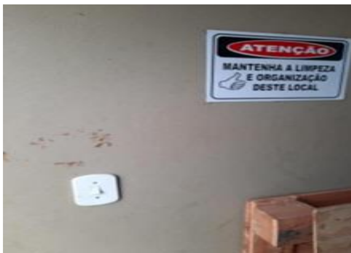
Figura 13 – Detalhamento da tomada no interior do depósito de armazenamento de agrotóxicos.
