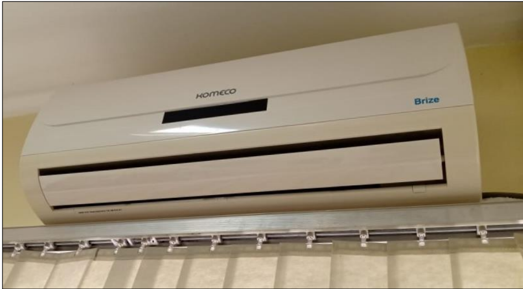
Figura 28 – Unidade evaporadora do equipamento.
