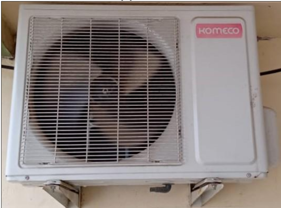
Figura 29 – Unidade condensadora do equipamento.
