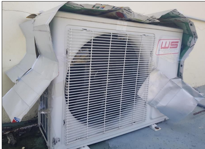
Figura 03– Vista externa do painel formado pela disposição das caixas Tetra Pak após higienização, na unidade condensadora do equipamento.
