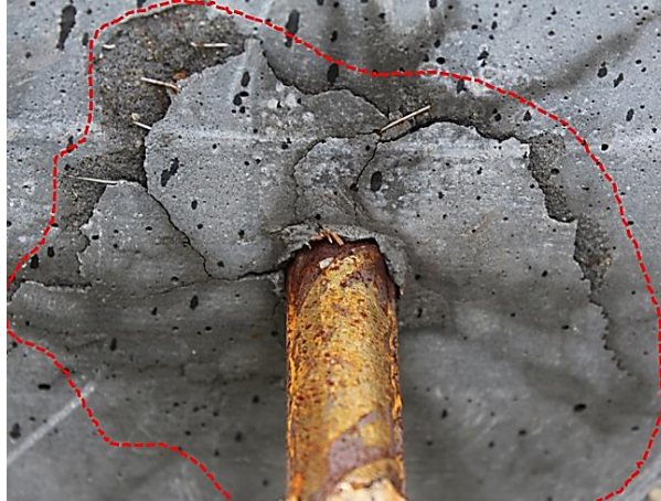
Figura 56 - Ruptura por aderência na extremidade da amostra C2.V.20
