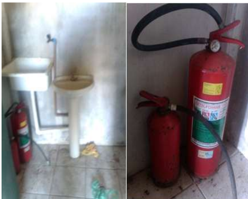
Figura 10 – Extintores do posto da ADDASG Fonte: Autora, 2017.
