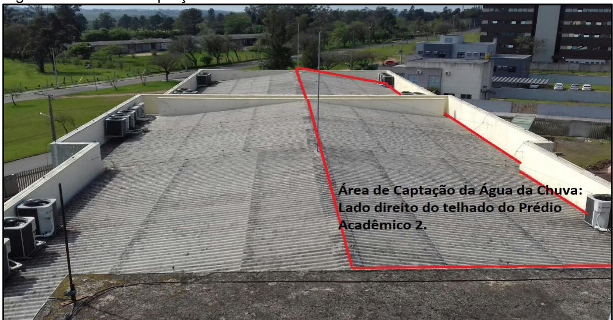
Figura 6 – Área de captação atual do sistema
