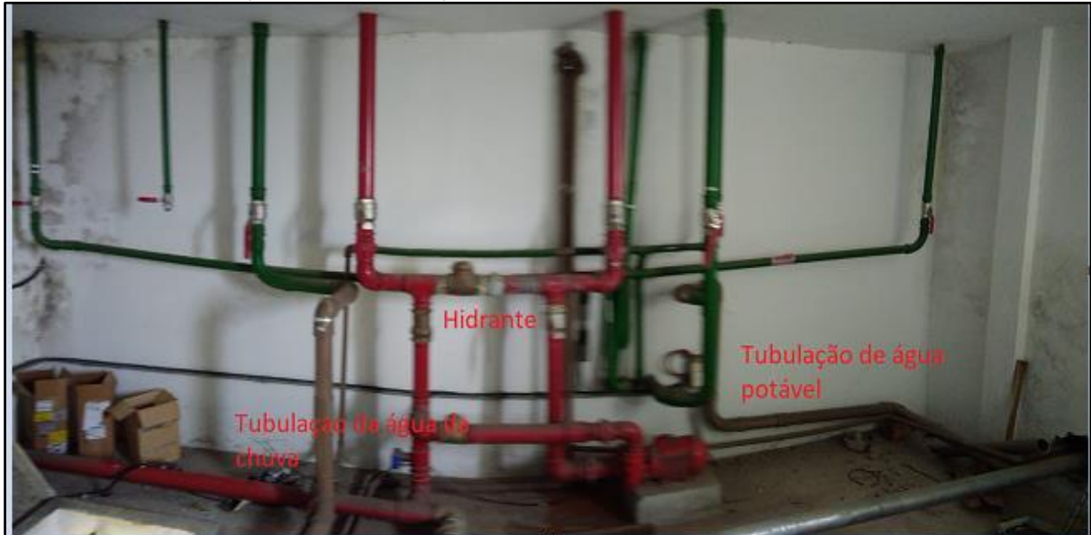
Figura 11 – Tubulação de distribuição da água para os pontos de abastecimento
