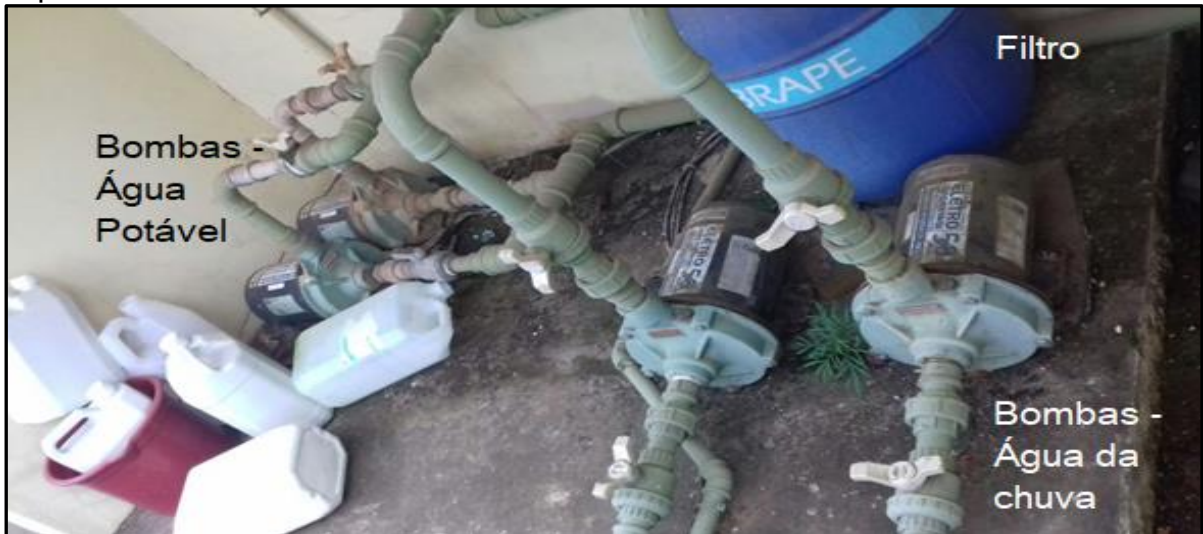
Figura 8 – Sistema de bombas que levam a água dos reservatórios inferiores até os superiores
