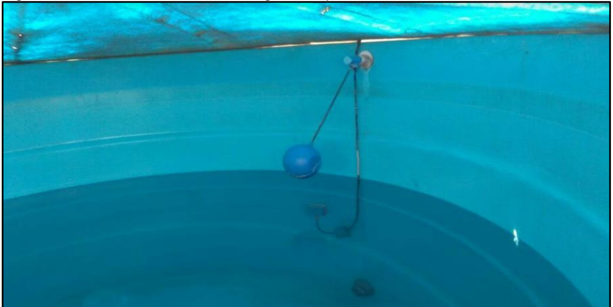
Figura 9 – Bóia do Reservatório de água não potável 3
