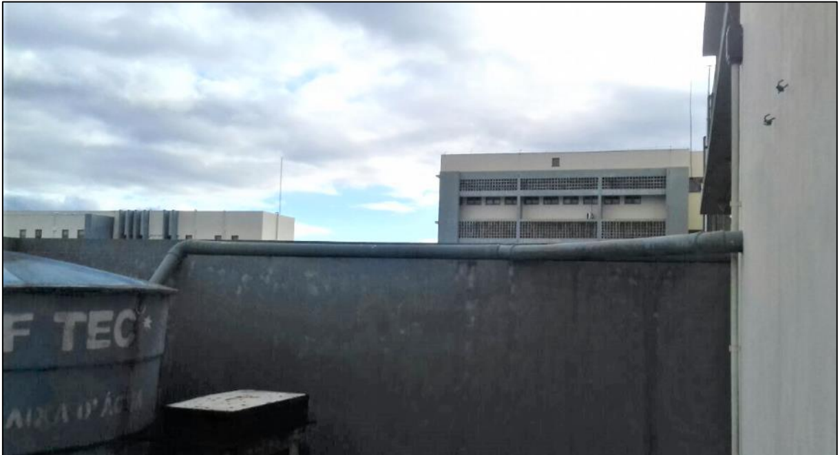
Figura 15 – Conduitos verticais que levam água coletada até os reservatórios
