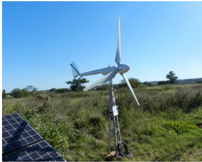
Figura 31 - Visita a Unipampa - Gerador eólico
