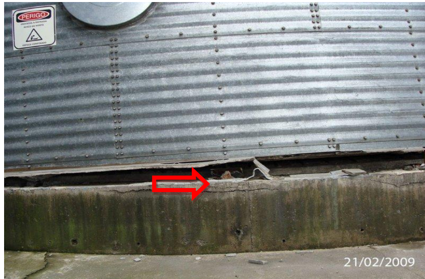
Figura 5.15 – Arrancamento de um silo da sua base devido a problemas na estrutura da base.
