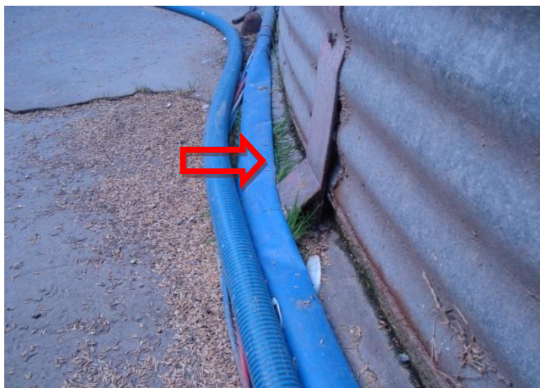
Figura 5.08 – Vegetação nas estruturas- agentes causadores de deterioração.
