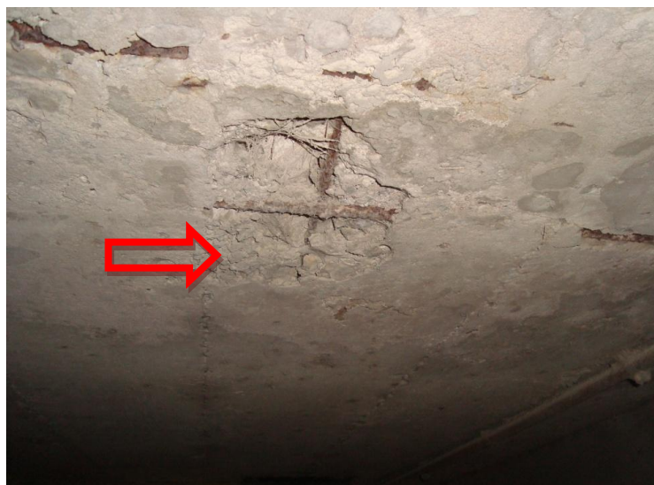
Figura 5.04 – Deslocamento causada pela corrosão da armadura.
