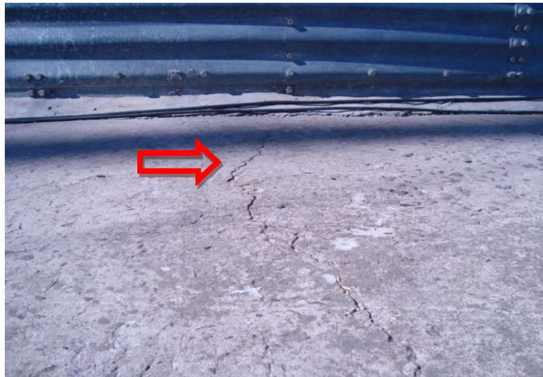
Figura 5.03 – Fissura na base do silo pela movimentação térmica.
