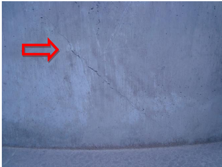
Figura 5.10 – Fissura por insuficiência estrutural.
