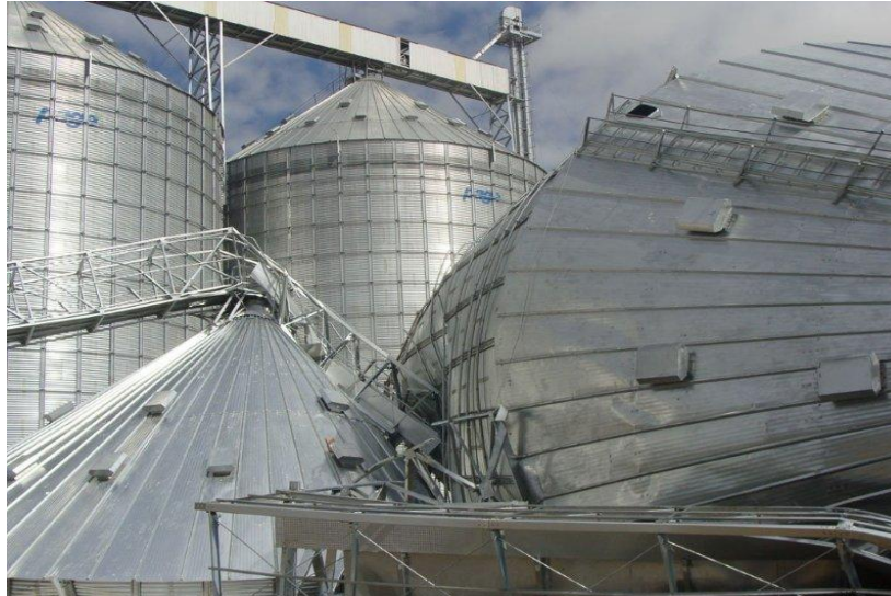
Figura 4.03 – Queda de silo devido a esforço do vento.
