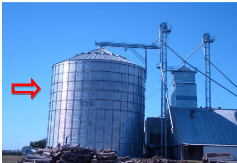
Figura 5.12 – Afundamento de base de silo.
