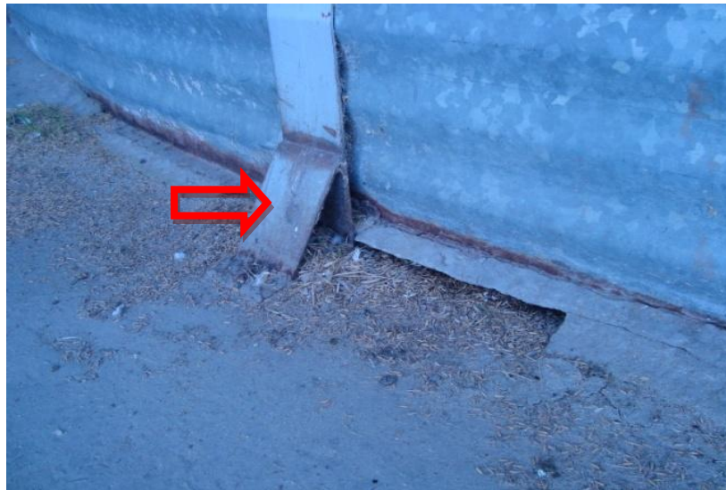
Figura 5.06 – Corrosão da estrutura metálica na união do concreto com a chapa.
