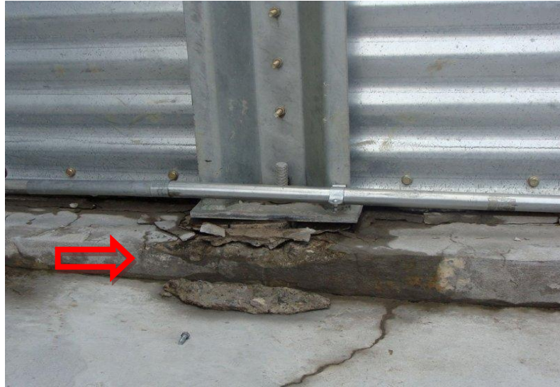
Figura 5.14 – Fissuras causadas por esforço causado pelo vento.
