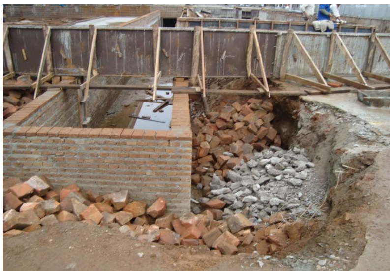
Figura 1.03 – Aterro com material graúdo, sem compactação adequada.
