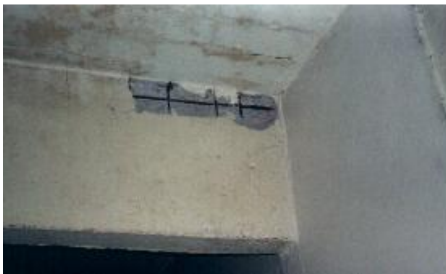
Figura 3.07– Desagregação do concreto devido à corrosão de armadura.
