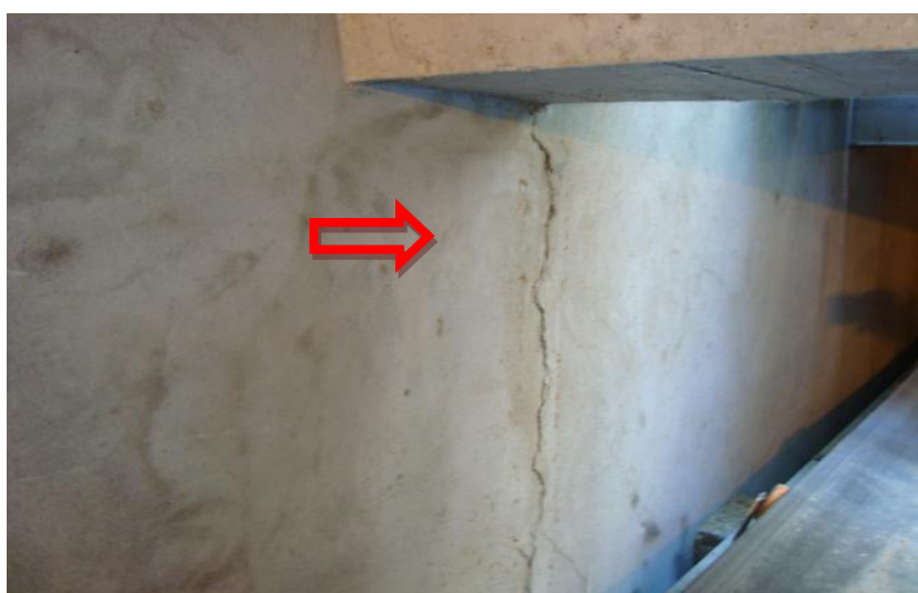
Figura 5.13 – Fissuras causadas pelo recalque na base do silo.
