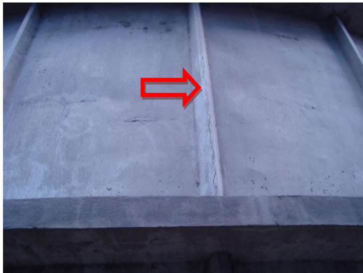
Figura 5.11 – Trincas em silo de concreto.
