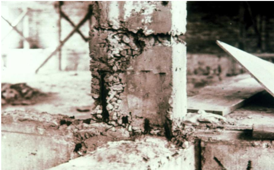
Figura 3.08 – Exemplo de segregação em pilar de uma edificação.
