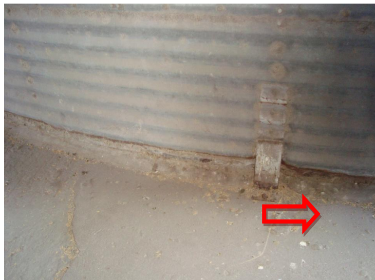
Figura 5.07 – Corrosão da estrutura metálica na união do concreto com a chapa.
