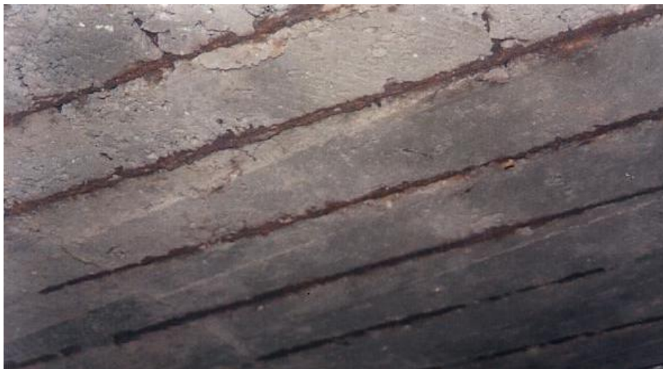
Figura 3.11 - Laje com corrosão generalizada e expansão da seção da armadura.
