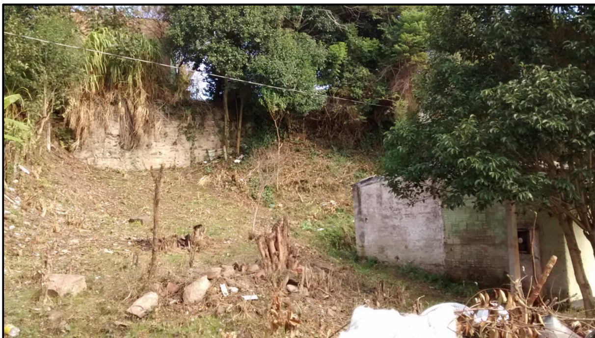
Figura 13- Espaçamento muito pequeno, entre a encosta e a casa.
