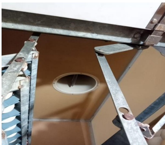
Figura 22 – Saída de ar pelos dampers
