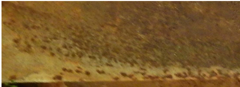
Figura 85 - L08 Montante - Corrosão alveolar
