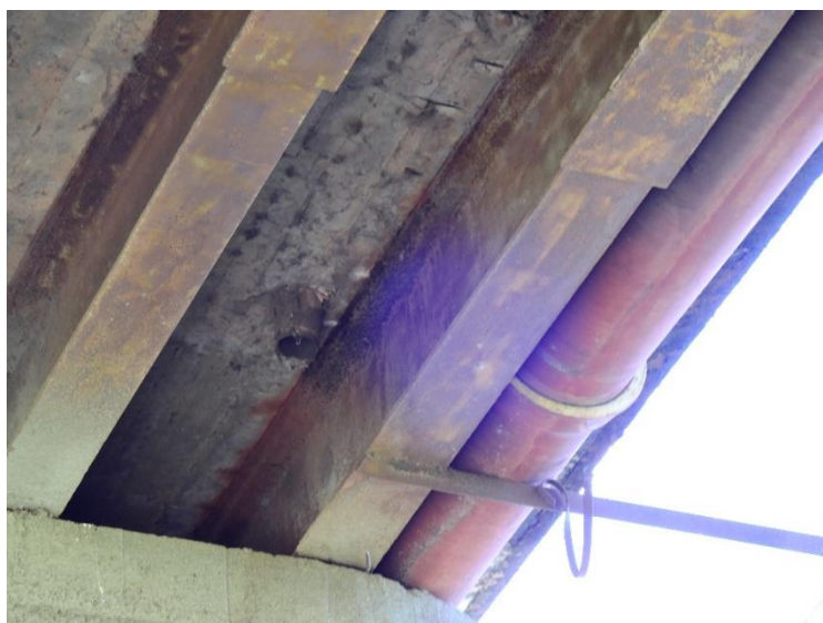
Figura 27- Tubulação de esgoto ao lado da viga 09
