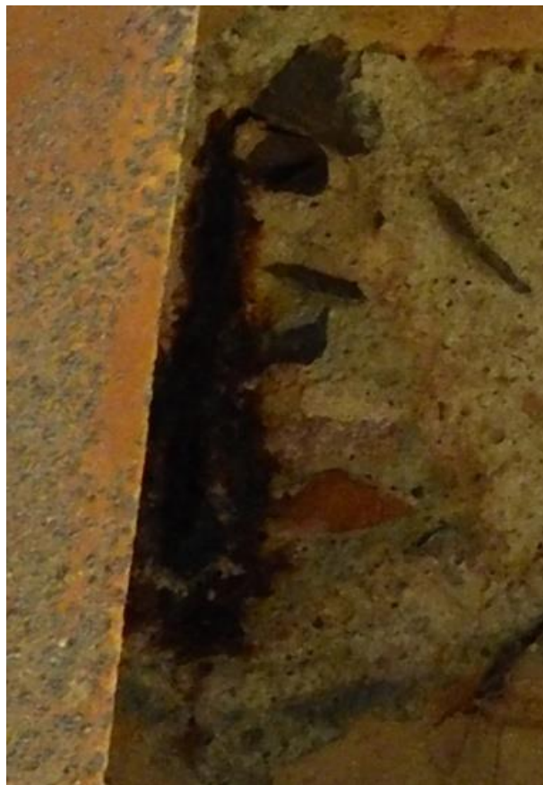
Figura 120 - Desplacamento do concreto e corrosão das armaduras - detalhe 4
