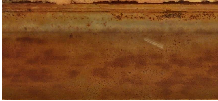
Figura 35 - L02 Montante - Corrosão por pites generalizada
