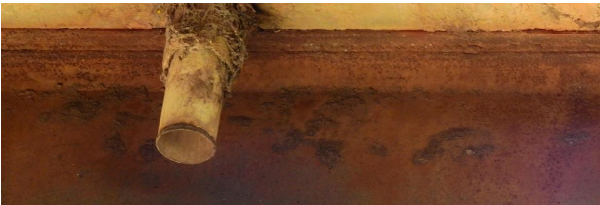
Figura 29 - L01 Montante - Corrosão mais avançada
