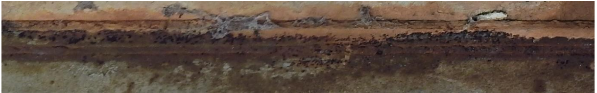
Figura 82 - L07 Jusante - Corrosão mais avançada
