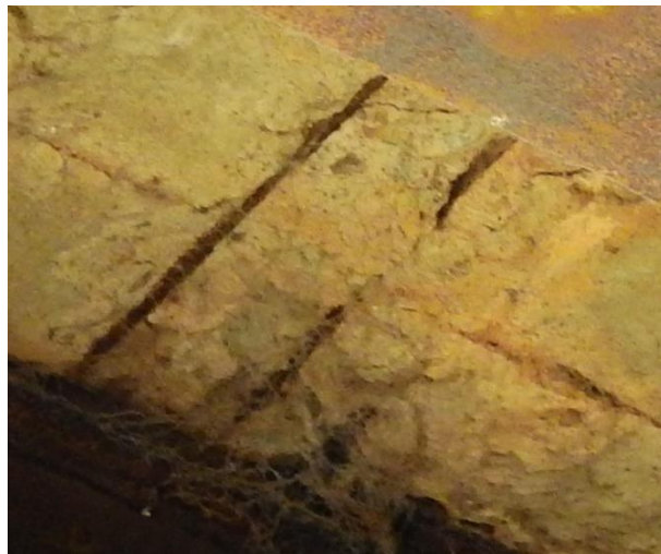
Figura 118 - Deslocamento do concreto e corrosão das armaduras - detalhe 2
