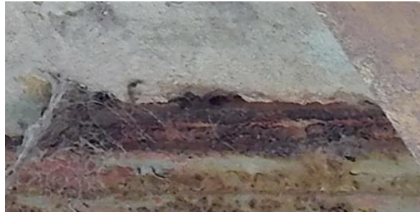
Figura 72 - L06 Jusante - Corrosão mais avançada
