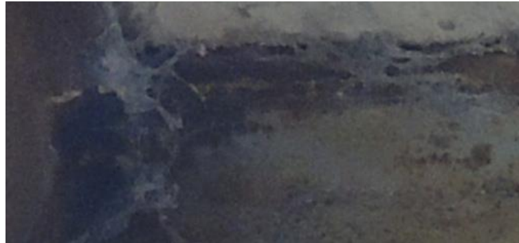
Figura 46 - L03 Jusante - Corrosão mais avançada
