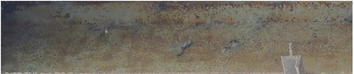
Figura 47 - L03 Jusante - Corrosão por pites generalizada
