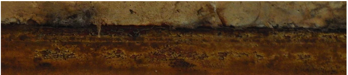
Figura 69 - L06 Montante - Descascamento por corrosão
