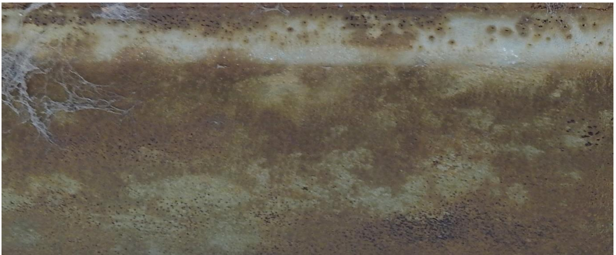
Figura 83 - L07 Jusante - Corrosão por pites generalizada
