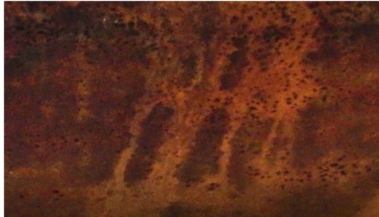
Figura 41 - L03 Montante - Corrosão alveolar
