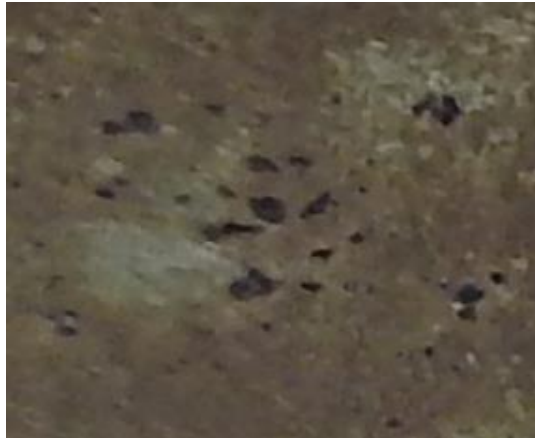
Figura 81 - L07 Jusante - Corrosão alveolar
