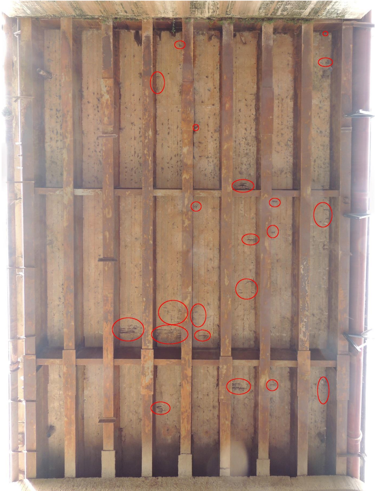
Figura 116 - Vista inferior do tabuleiro com diversas manifestações patológicas identificadas
