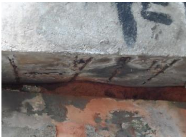
Figura 3 - Corrosão das armaduras
