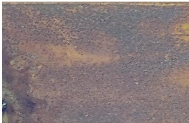
Figura 98 - L09 Jusante - Corrosão por pites generalizada
