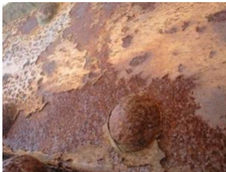
Figura 12 - Corrosão uniforme em ponte
