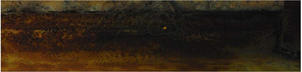
Figura 78 - L07 Montante - Corrosão mais avançada
