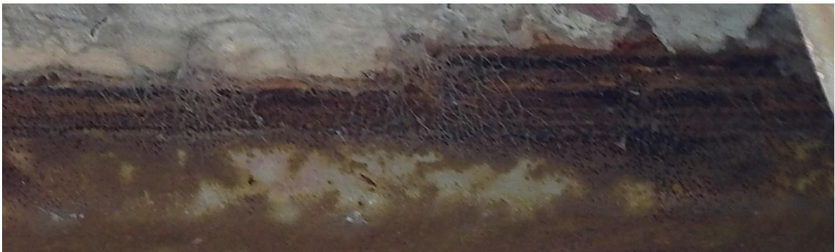
Figura 92 - L08 Jusante - Corrosão mais avançada
