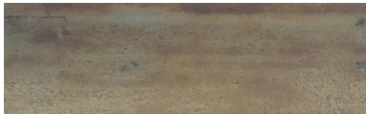
Figura 63 - L05 Jusante - Corrosão por pites generalizada
