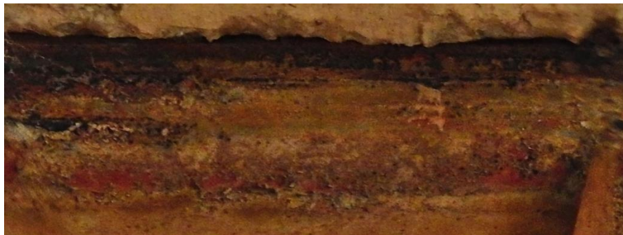
Figura 60 - L05 Montante - Descascamento por corrosão
