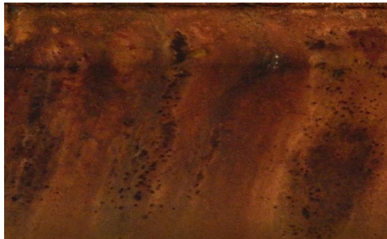
Figura 33 - L02 Montante - Corrosão alveolar
