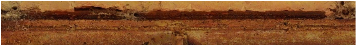
Figura 42 - L03 Montante - Corrosão mais avançada
