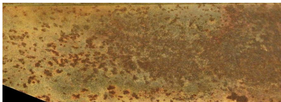
Figura 77 - L07 Montante - Corrosão alveolar
