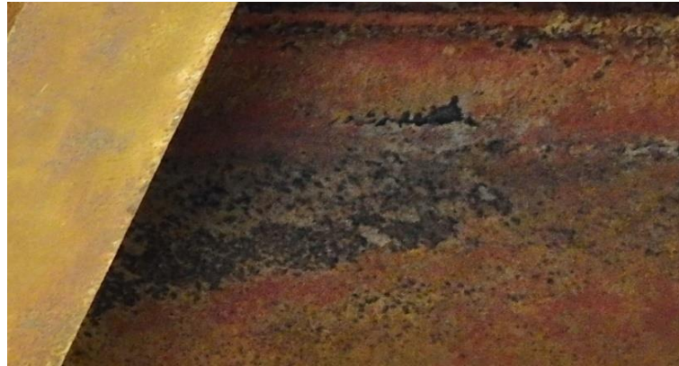
Figura 44 - L03 Montante - Descascamento por corrosão
