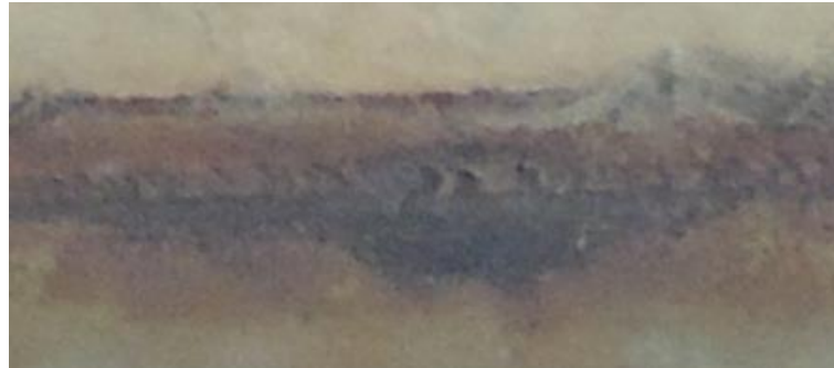
Figura 55 - L04 Jusante - Corrosão mais avançada
