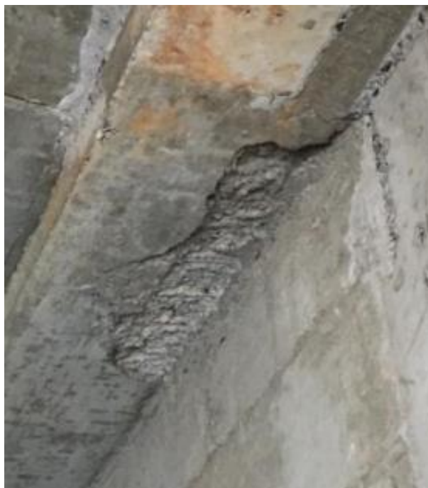
Figura 5 - Desagregação do concreto
