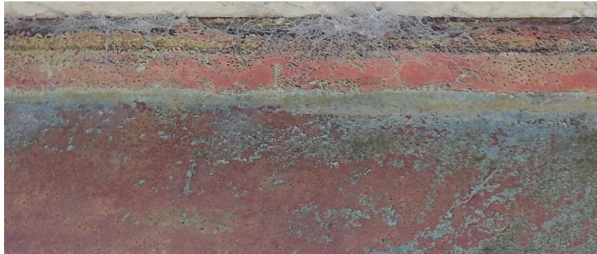
Figura 75 - L06 Jusante - Descascamento por corrosão
