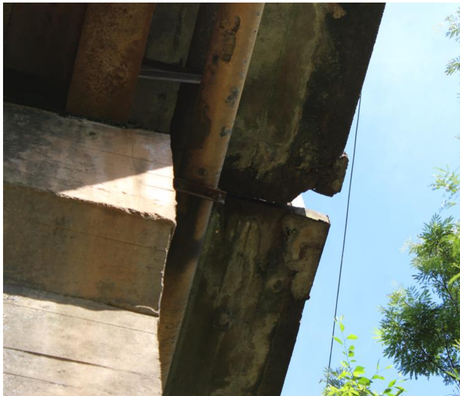
Figura 121 - Manchas de infiltração no tabuleiro - detalhe 1
