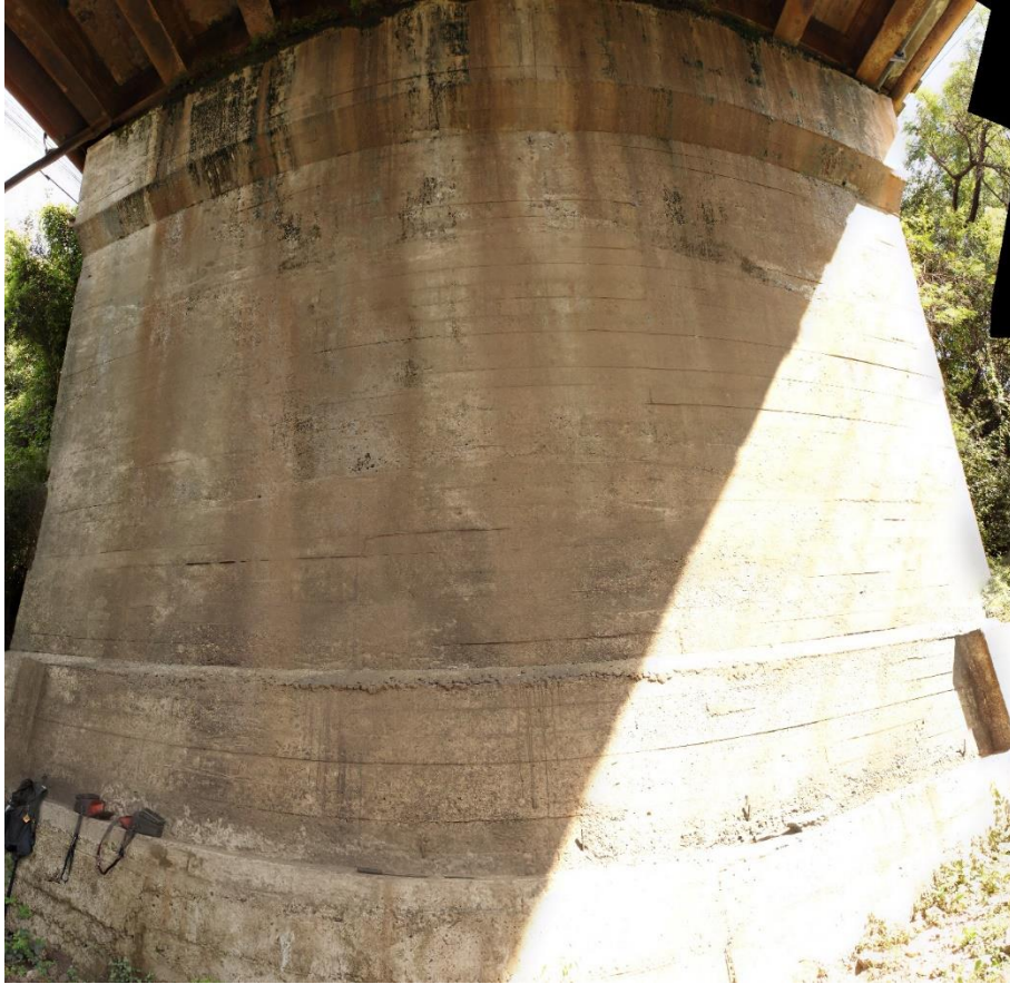
Figura 123 - Pilar de concreto com pontos de segregação
