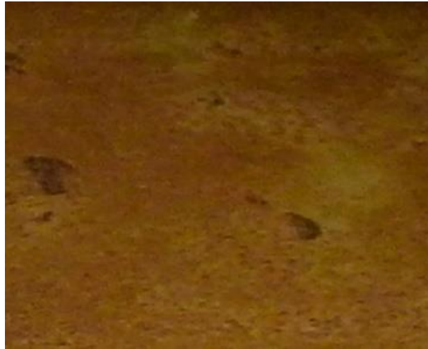
Figura 104 - T02AB - Corrosão alveolar
