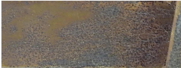
Figura 111 - T02VA - Corrosão por pites generalizada
