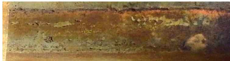
Figura 115 - T03VA - Descascamento por corrosão
