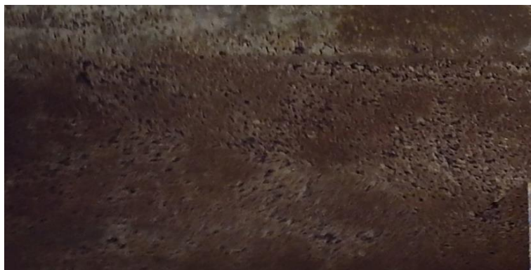
Figura 112 - T02VA - Descascamento por corrosão
