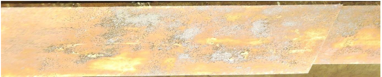
Figura 36 - L02 Montante - Descascamento por corrosão
