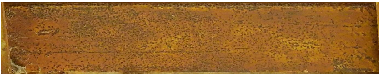
Figura 106 - T02AB - Corrosão por pites generalizada
