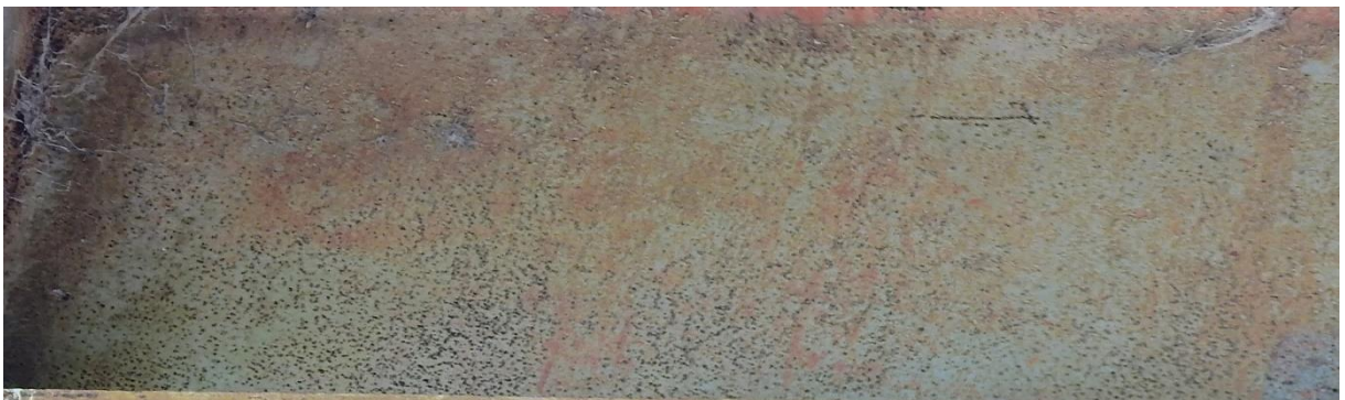
Figura 74 - L06 Jusante - Corrosão por pites generalizada
