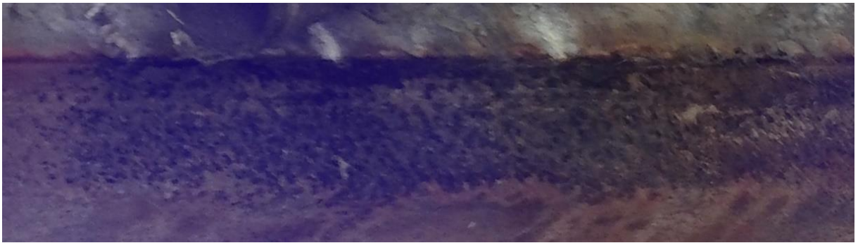
Figura 97 - L09 Jusante - Corrosão mais avançada
