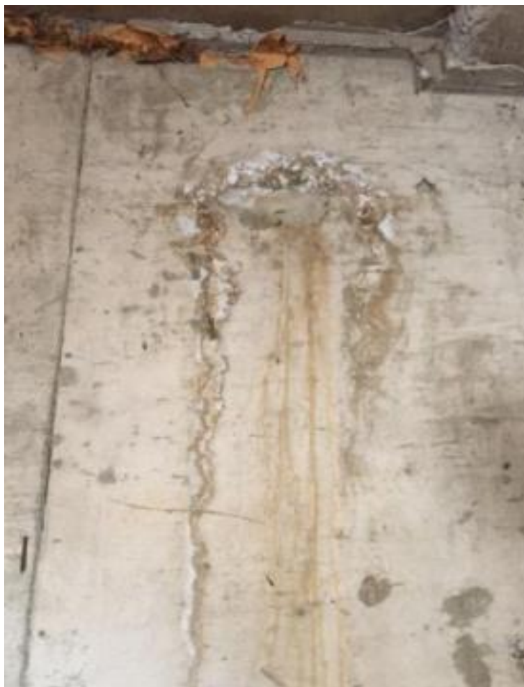
Figura 2 - Eflorescência em viga
