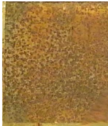
Figura 114 - T03VA - Corrosão por pites generalizada
