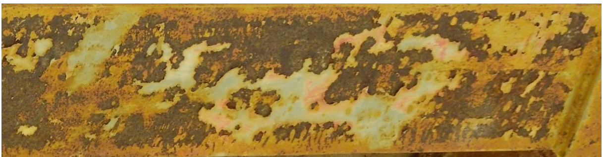
Figura 89 - L08 Montante - Descascamento por corrosão
