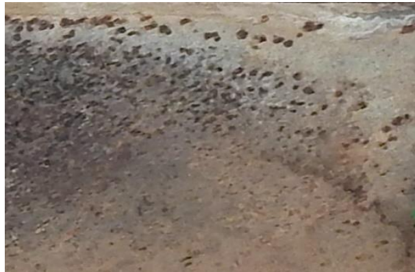
Figura 91 - L08 Jusante - Corrosão alveolar
