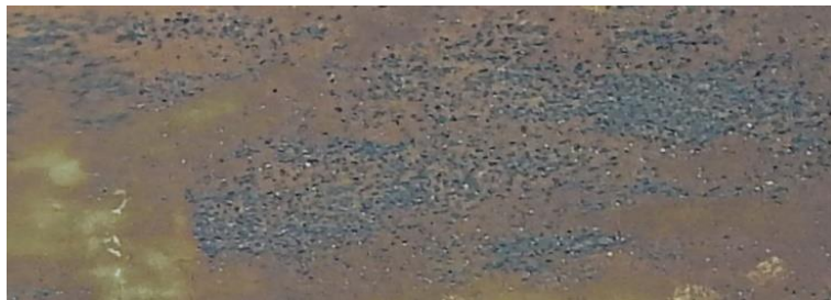
Figura 94 - L08 Jusante - Corrosão por pites generalizada
