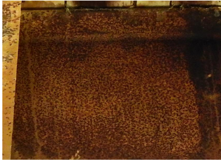
Figura 102 - T01AB - Corrosão por pites generalizada
