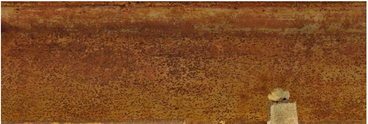
Figura 43 - L03 Montante - Corrosão por pites generalizada
