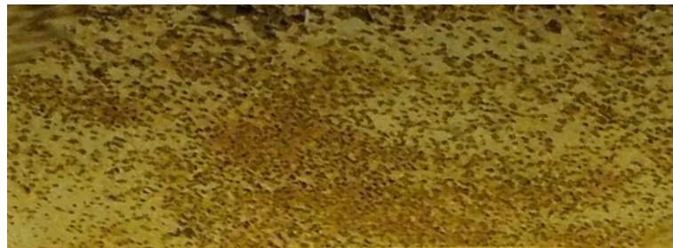
Figura 88 - L08 Montante - Corrosão por pites generalizada
