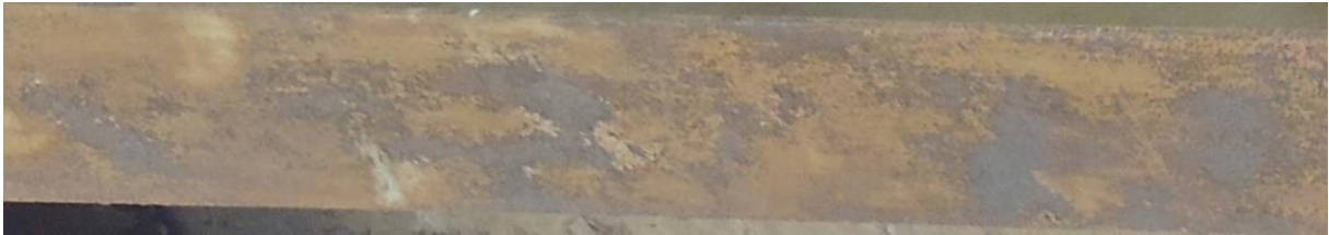
Figura 39 - L02 Jusante - Descascamento por corrosão
