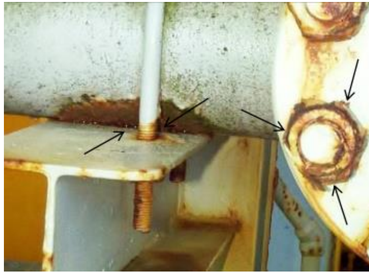
Figura 16 - Corrosão fresta entre tubulação e perfil metálico suporte
