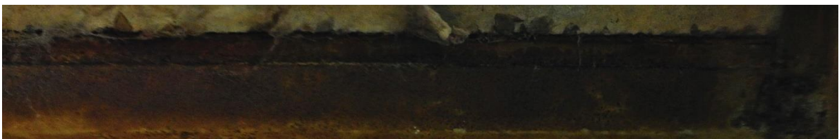
Figura 86 - L08 Montante - Corrosão mais avançada
