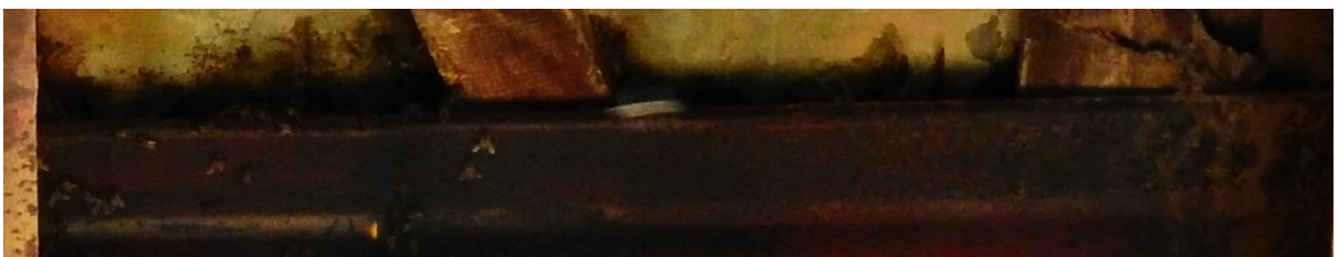
Figura 101 - T01AB - Corrosão mais avançada
