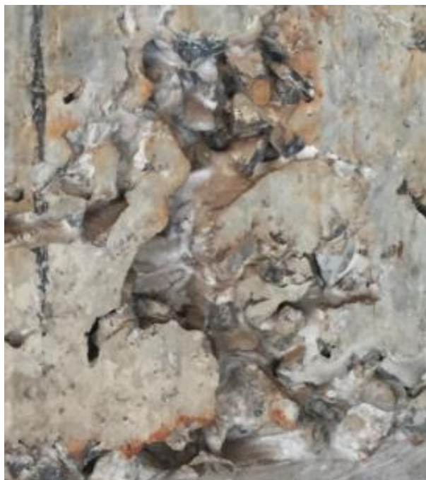
Figura 7 - Segregação do concreto
