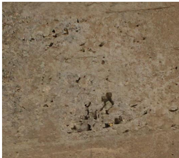
Figura 124 - Segregação do concreto
