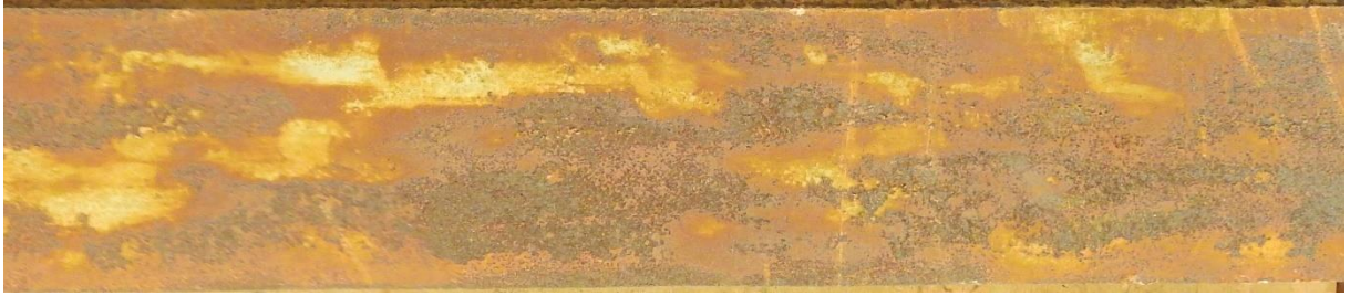
Figura 52 - L04 Montante - Descascamento por corrosão
