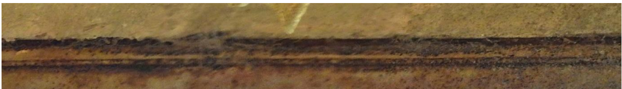
Figura 34 - L02 Montante - Corrosão mais avançada
