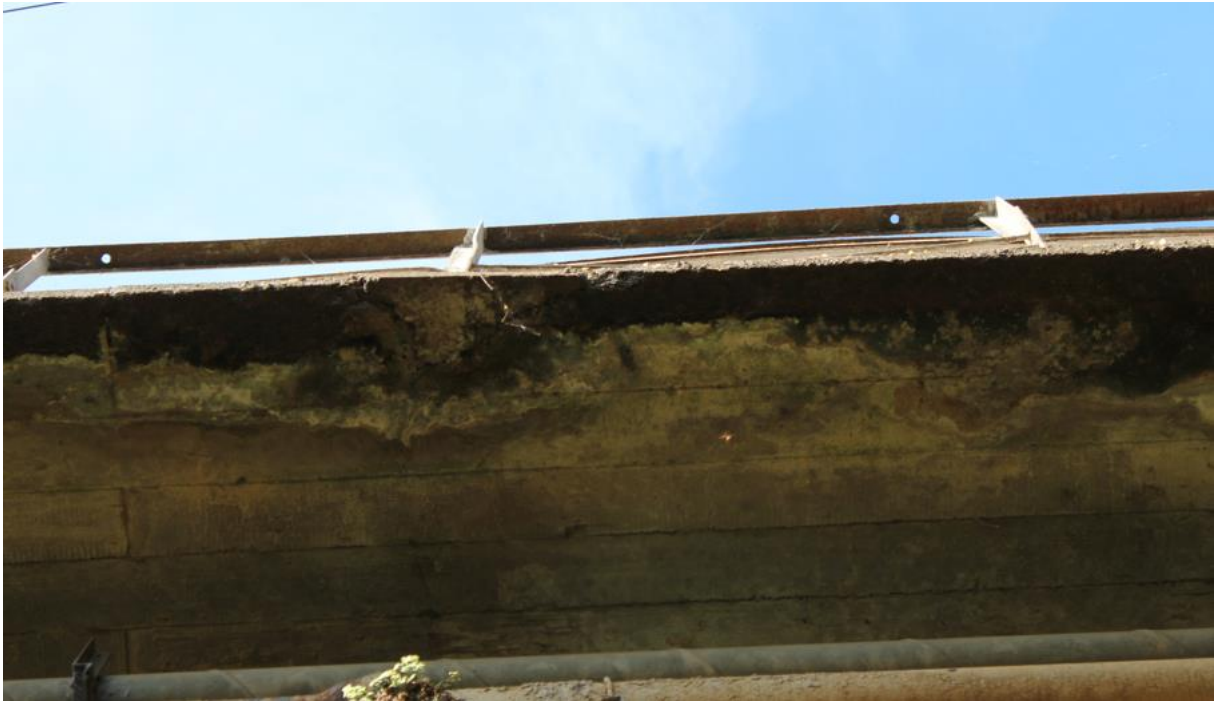
Figura 122 - Manchas de infiltração no tabuleiro - detalhe 2
