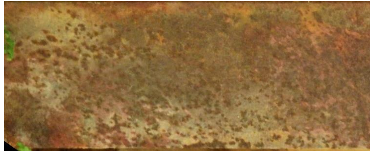
Figura 66 - L06 Montante - Corrosão alveolar
