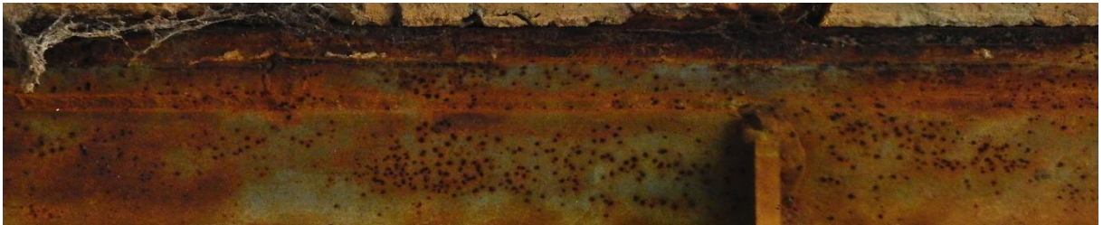
Figura 79 - L07 Montante - Corrosão por pites generalizada
