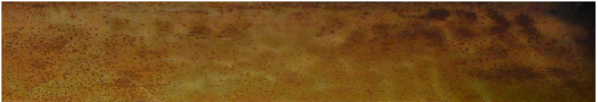
Figura 59 - L05 Montante - Corrosão por pites generalizada
