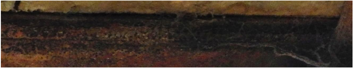
Figura 58 - L05 Montante - Corrosão mais avançada
