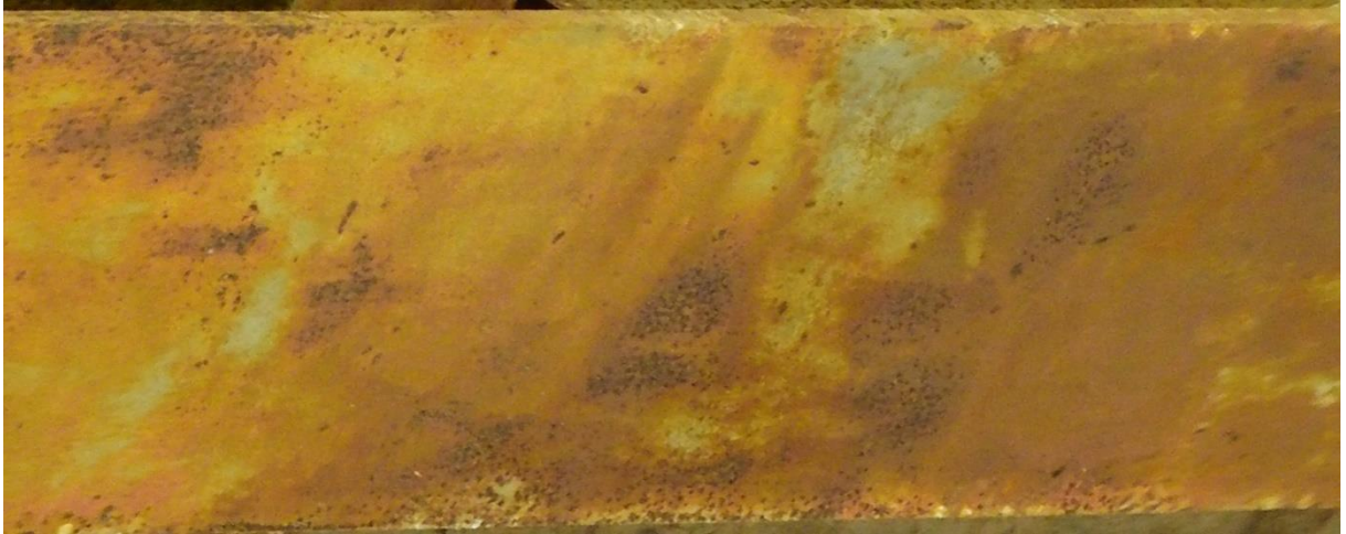
Figura 87 - L08 Montante - Corrosão por pites
