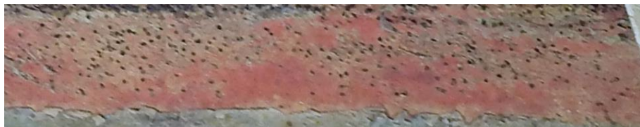
Figura 73 - L06 Jusante - Corrosão por pites
