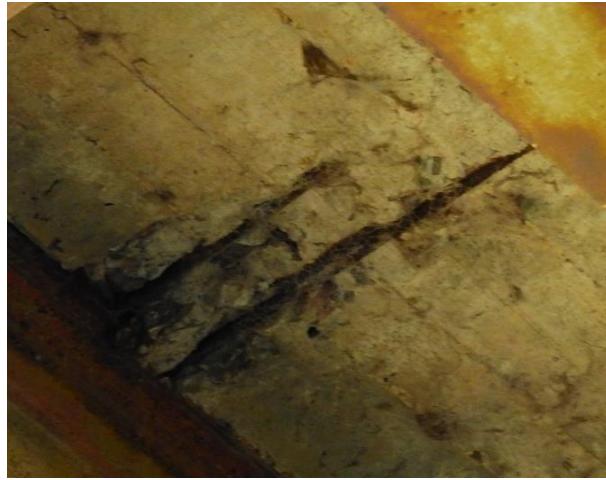
Figura 119 - Desplacamento do concreto e corrosão das armaduras - detalhe 3
