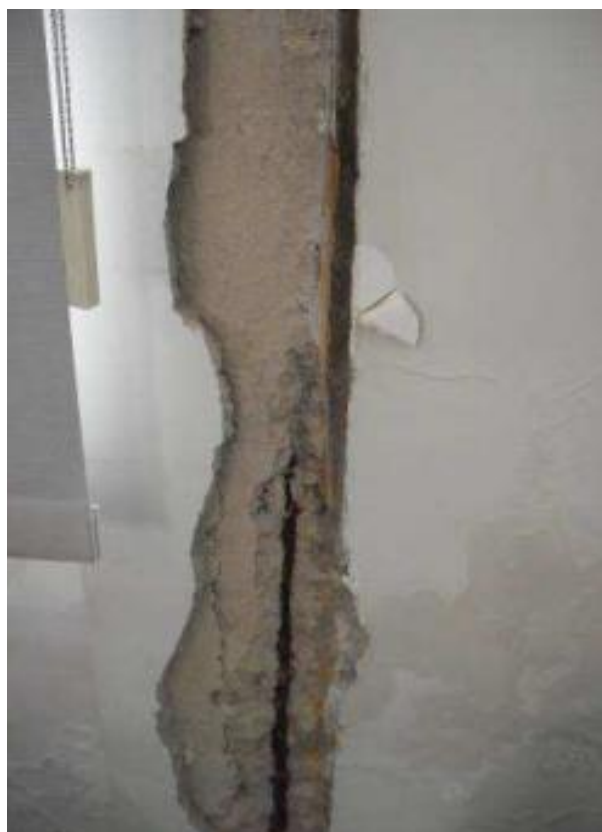
Figura 6 - Disgregação do concreto
