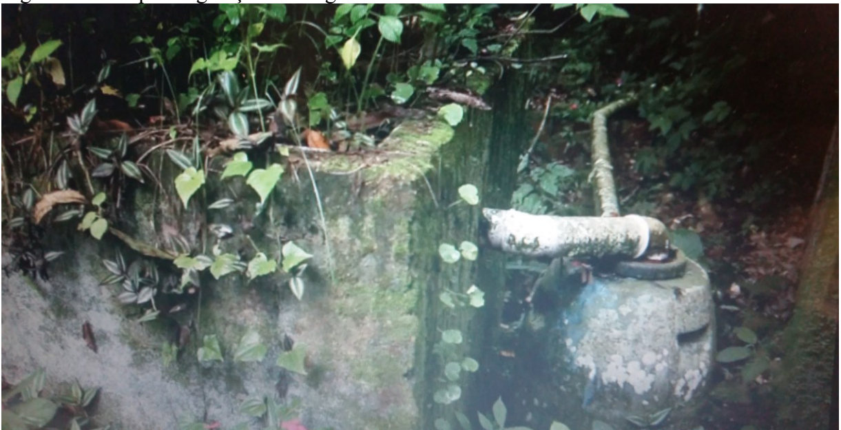
Figura 17: Tanque de geração de biogás
