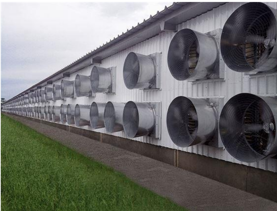
FIGURA 14 - Sistema de exaustão utilizada pela fazenda Colorado para manutenção da pressão negativa do galpão. Foto retirada do site www.agripoint.com.br .
