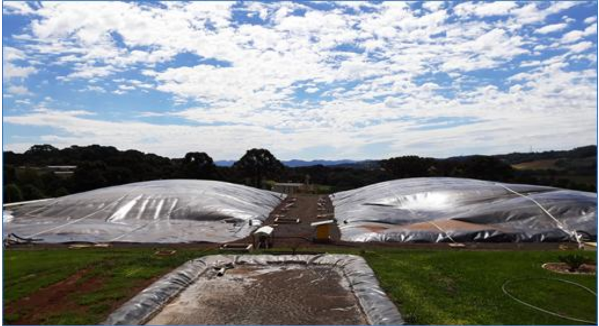
FIGURA 18 - Biodigestores cobertos com mantas plásticas semiflexíveis. Fonte: Arquivo pessoal.
