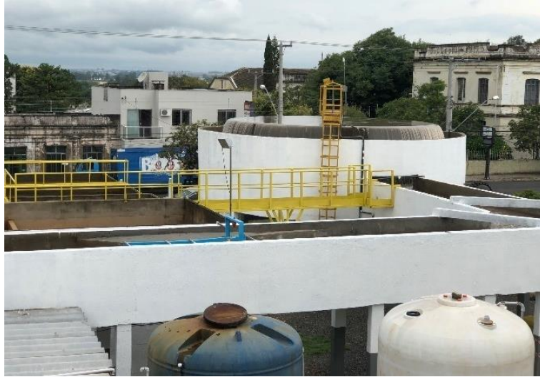
Figura 20 - Concessionária BRK, Entrada do Sistema de Tratamento (ETA).
