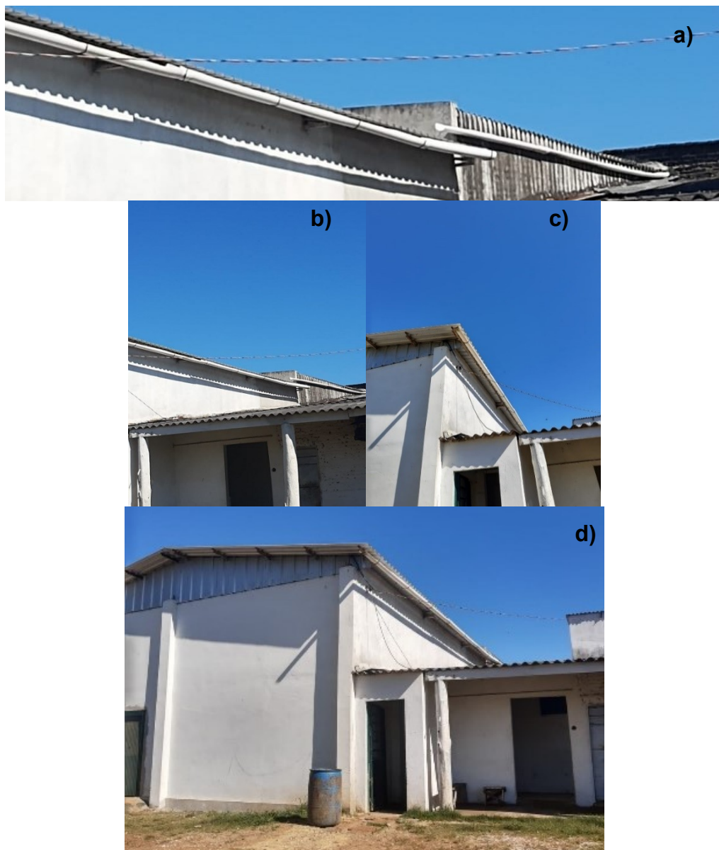
Figura 13 - Sistema de captação de água da chuva
