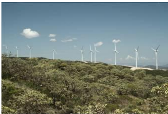
Figura 22- Complexo Eólico do Alto Sertão I. (Fonte: RENOVA ENERGIA, 2014)
