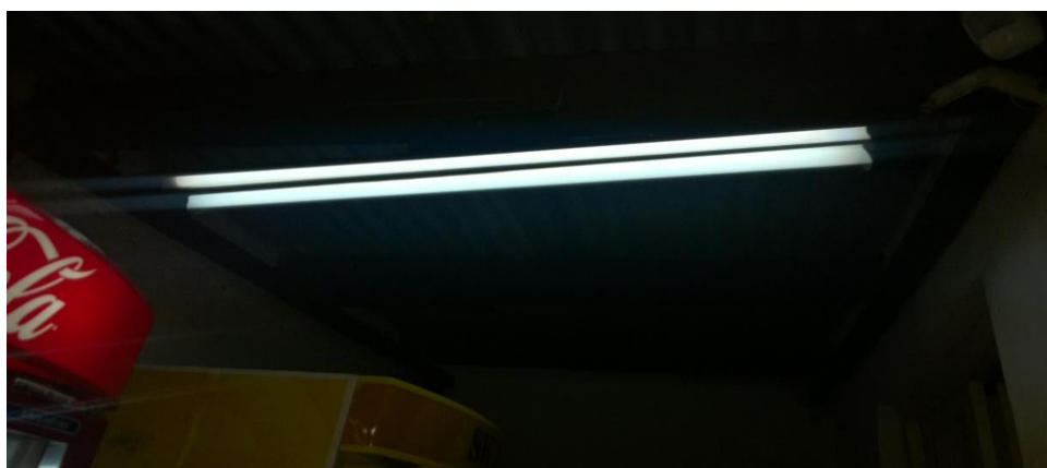
Figura 13 - Lâmpada fluorescente corredor Fonte: ALVES, B (2014)
