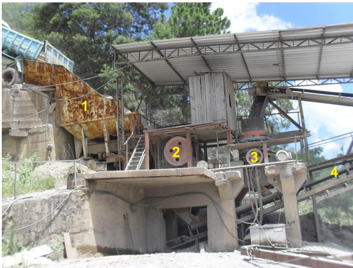
Figura 14 – Detalhe da unidade de britagem de minério (1- britagem primária, 2 – britagem secundária, 3 – britagem terciária) e localização do ponto de amostragem (4).
