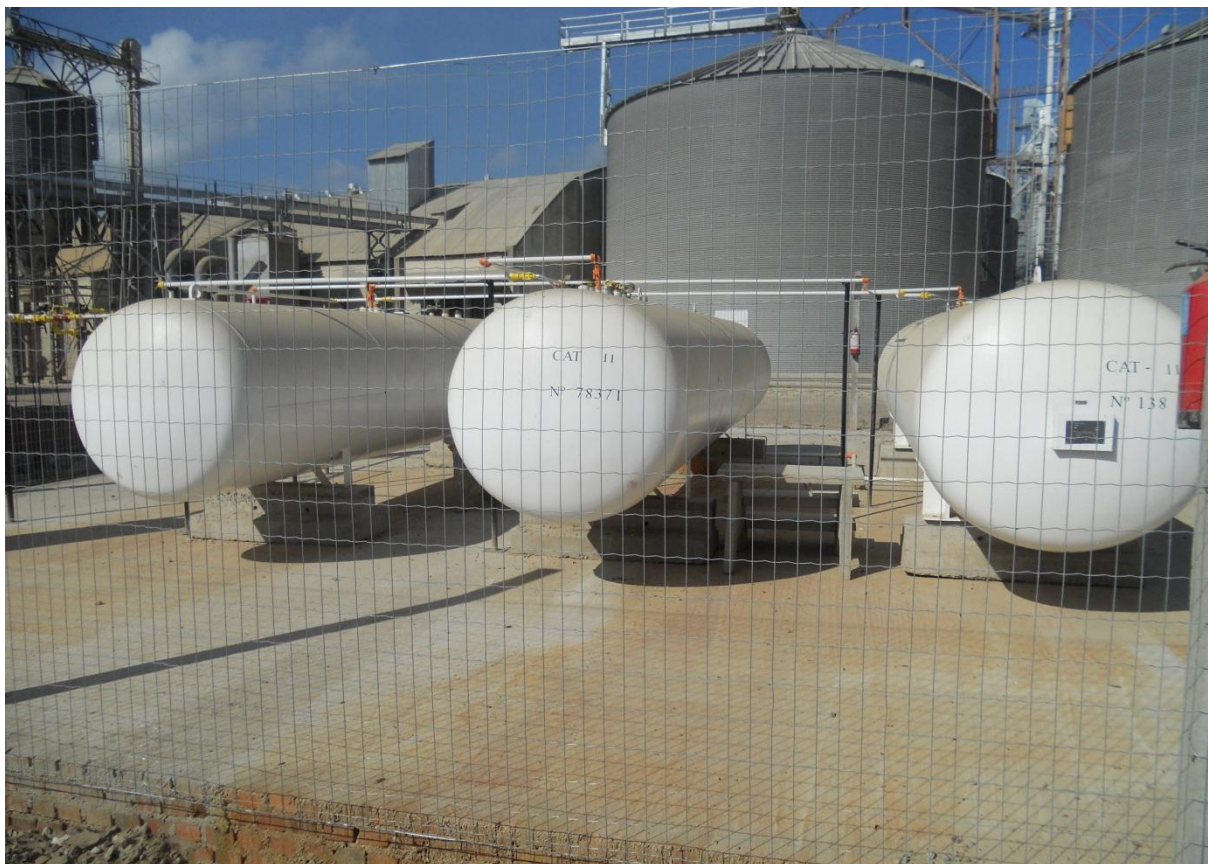
Figura 6–Tanques de armazenamento do gás GLP
