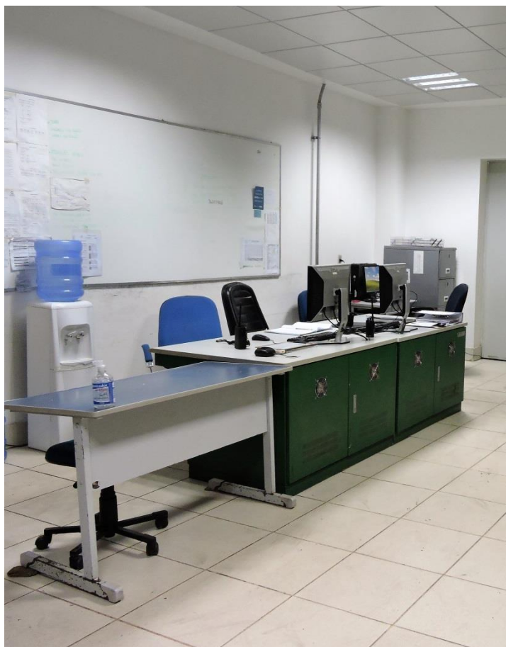
Figura 25 - Sala de comando do tratamento de águas
