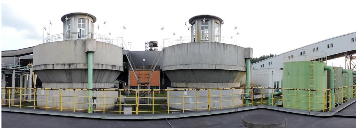
Figura 21 - Pré-tratamento de água
