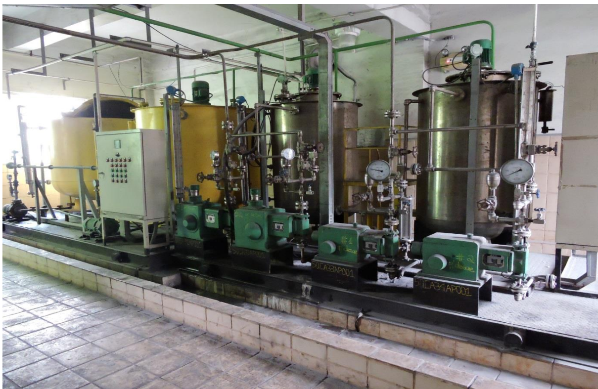
Figura 23 - Sistema de dosagem de produtos químicos
