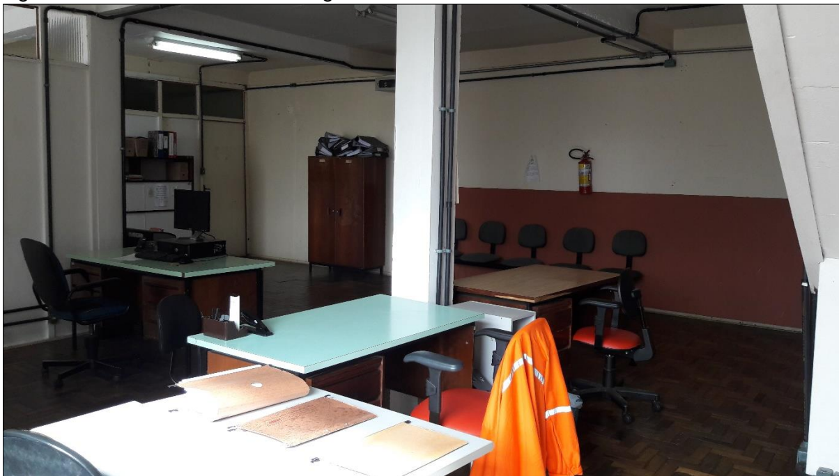
Figura 50 – Extintor instalado em lugares com obstáculos
