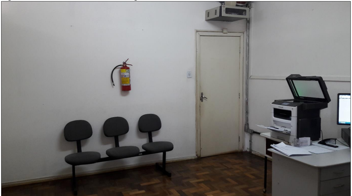
Figura 49 – Extintor instalado em lugares com obstáculos
