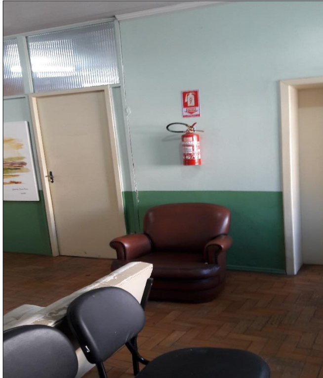
Figura 45 – Extintores instalados em lugares com obstáculos
