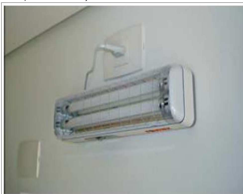
Figura 19 – Dispositivo de iluminação
