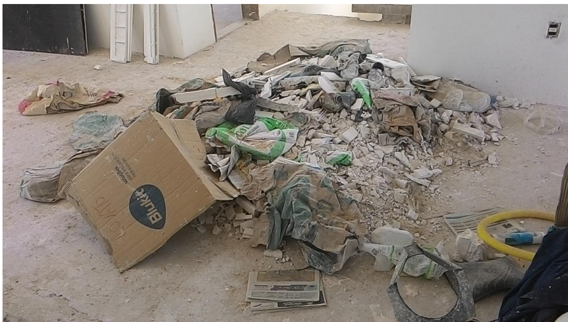
Figura 10 - Resíduos gerados na obra todos misturado
