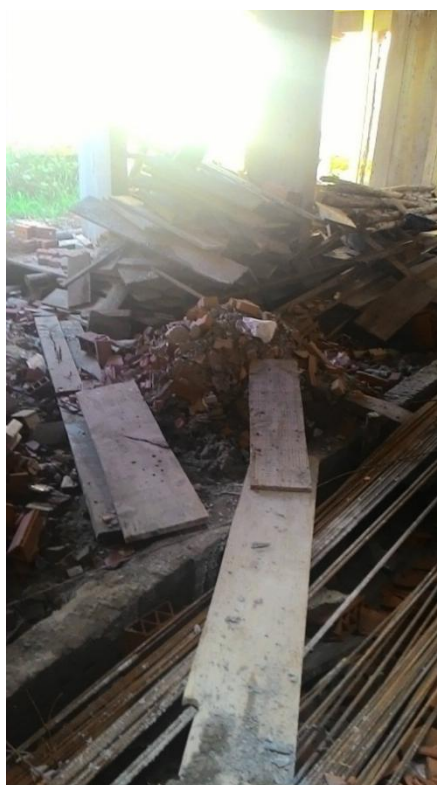
Figura 18 - Canteiro de obras mal organizado
