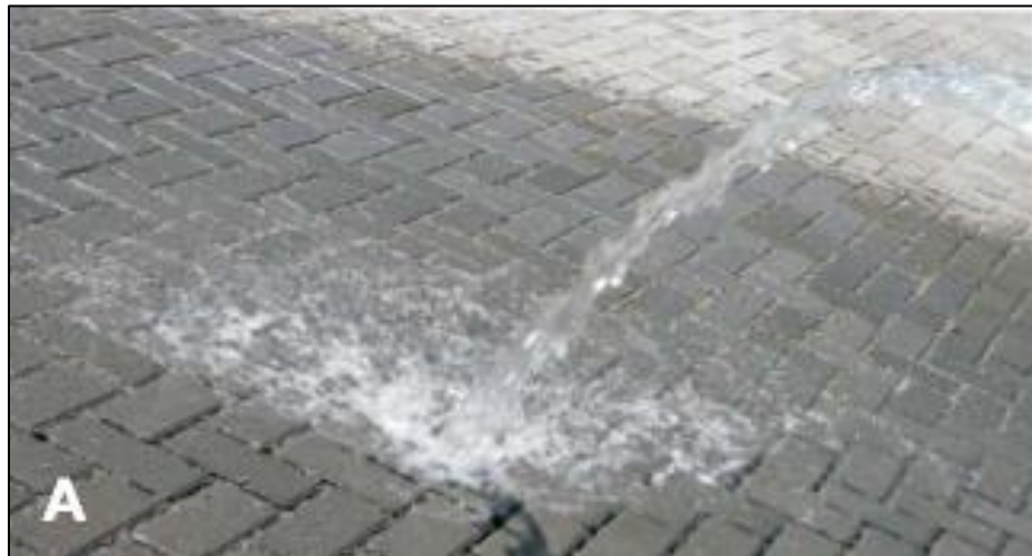
Figura 6 – Peças de concreto com juntas alargadas
