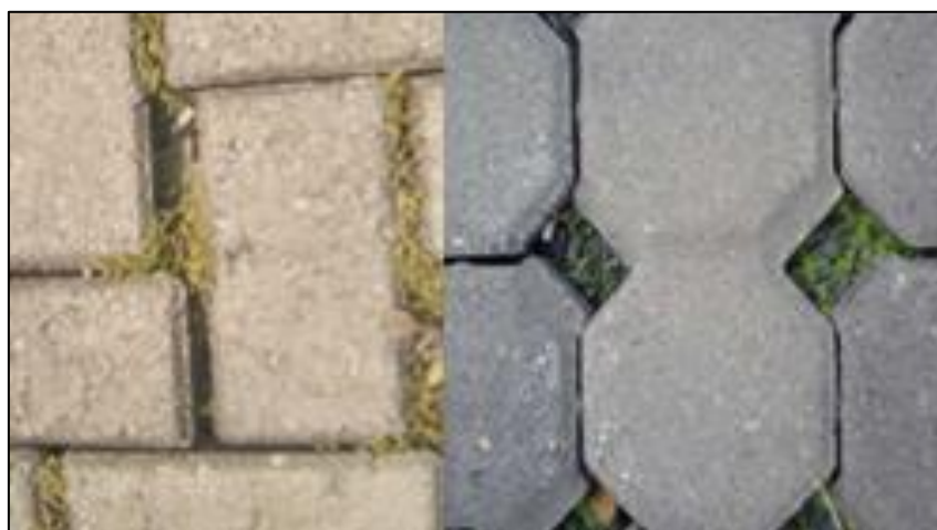
Figura 19 – Crescimento de vegetação nas juntas de pavimento permeáveis
