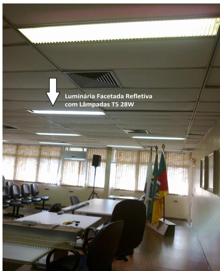
Fig.3.17. Luminária Facetada Refletiva com lâmpadas eficientes instalada no CAM
