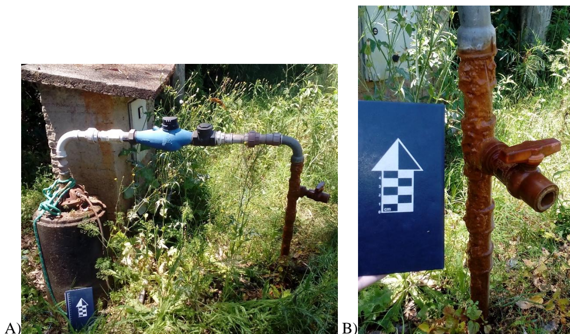
Figura 35 – Situação do P6. A) Notar ervas-daninhas altas inclusive ao redor do poço. B) Detalhe para o encanamento muito oxidado e com vazamento.
