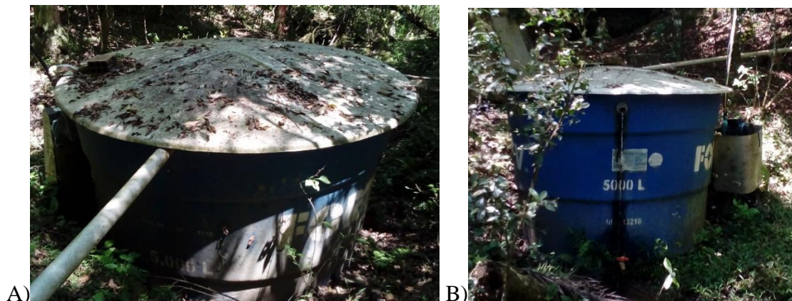
Figura 28 – Caixa d'água de plástico, a qual está acoplada a bomba e é responsável por enviar a água para as caixas d'água particulares. A) Caixa vista a partir da caixa de tijolos como referencial. B) Caixa vista a 90° em relação a foto A, ilustrando o ladrão e a bomba.
