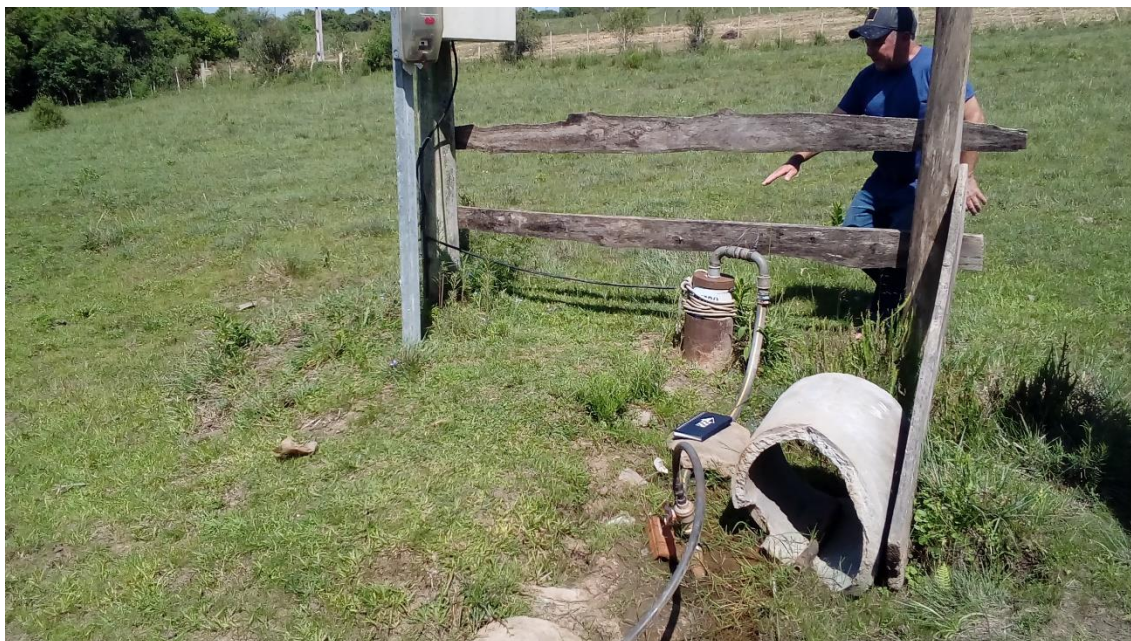
Figura 24 – Vista detalhada da situação do poço.
