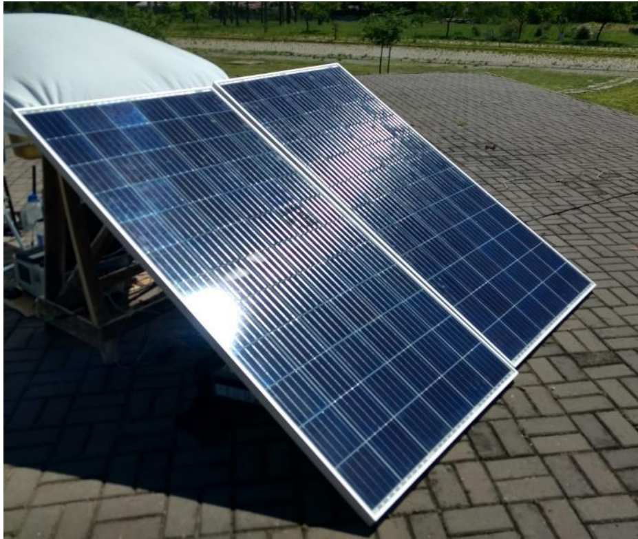
Figura 15 - Módulos fotovoltaicos utilizados nos ensaios.
