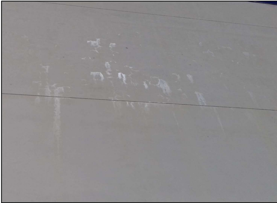
Figura 28 - Manchas de Umidade
