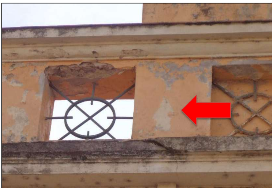
Figura 13 - Desagregação da pintura
