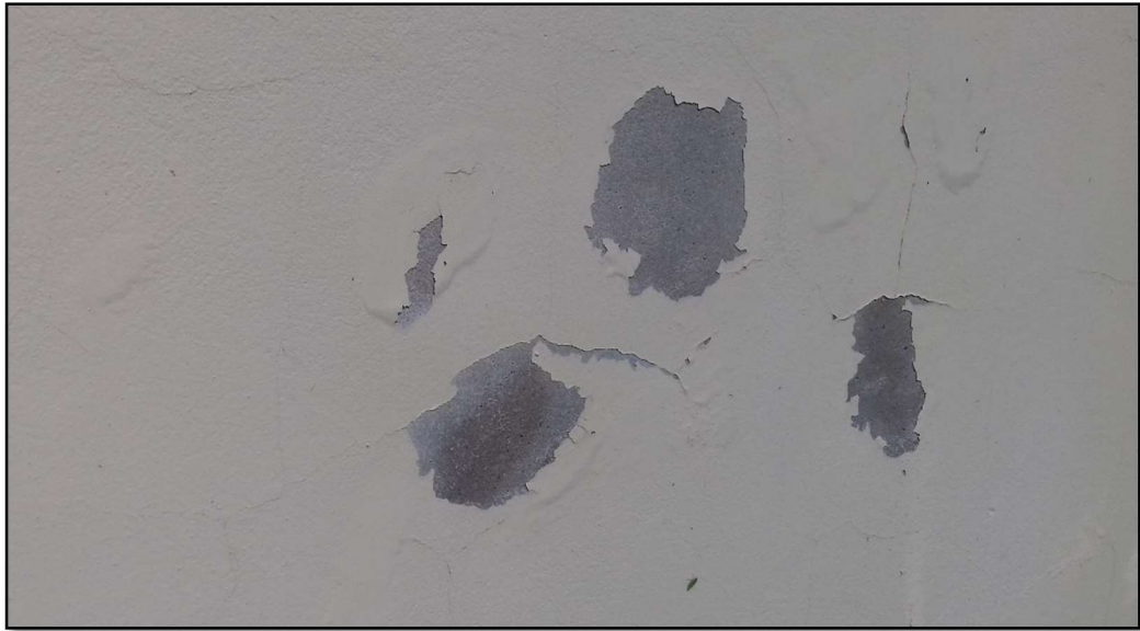
Figura 36 - Patologias encontradas na Fachada 2
