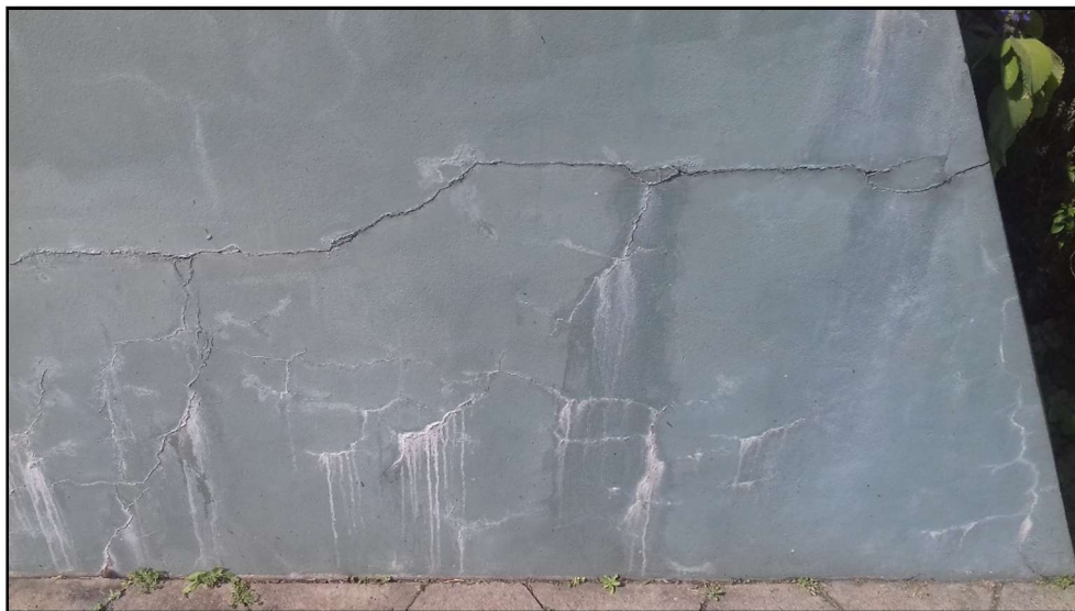
Figura 42 – Imagem aproximada da base da fachada
