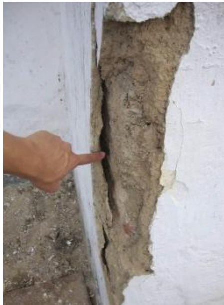
Figura 2: Deslocamento da argamassa de revestimento.
