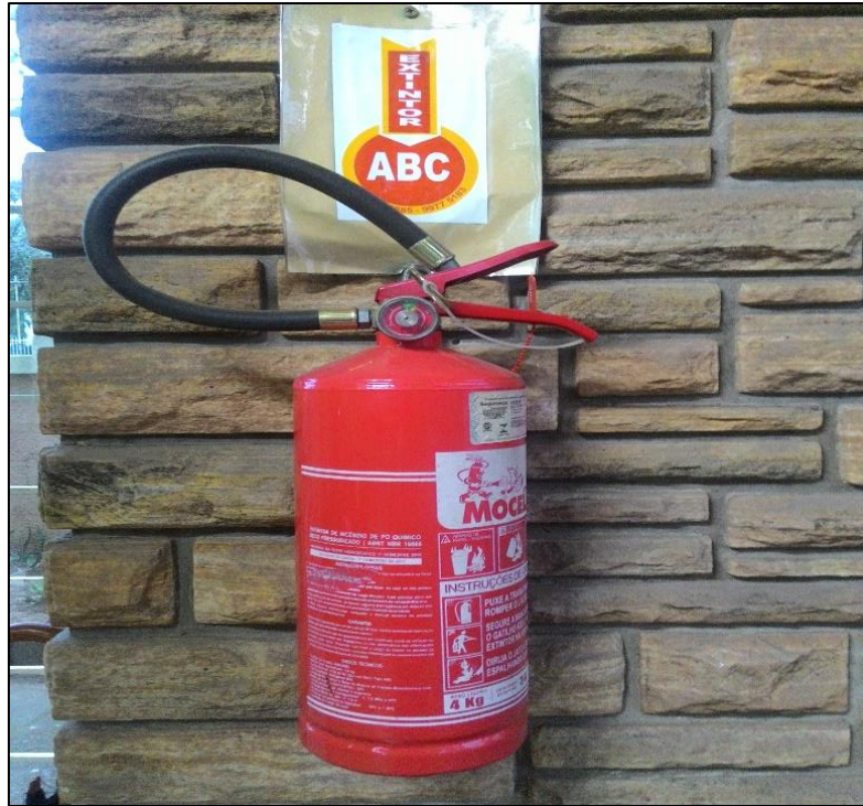
Figura 50 - Extintor ABC / Bloco 1
