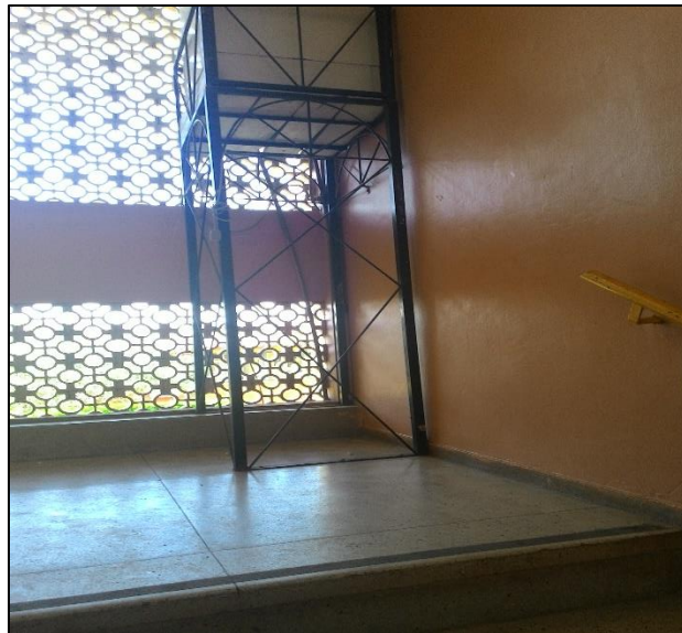
Figura 60- Bloqueio no patamar / Bloco 3
