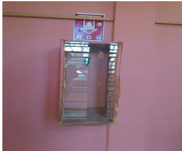
Figura 65 - Caixa de proteção sem extintor / Bloco 7
