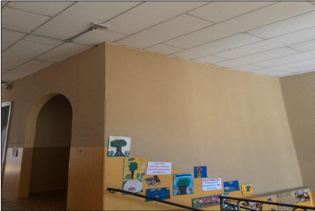
Figura 72 - Iluminação de balizamento / Bloco 3
