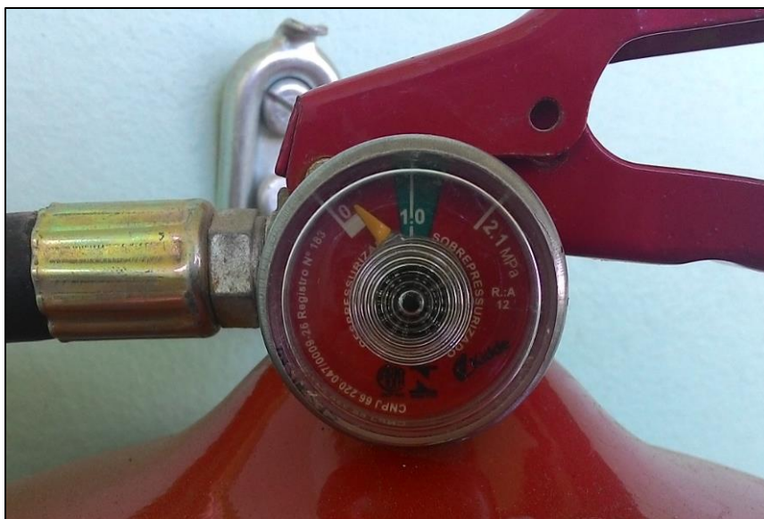
Figura 75 - Extintor despressurizado / Bloco 1
