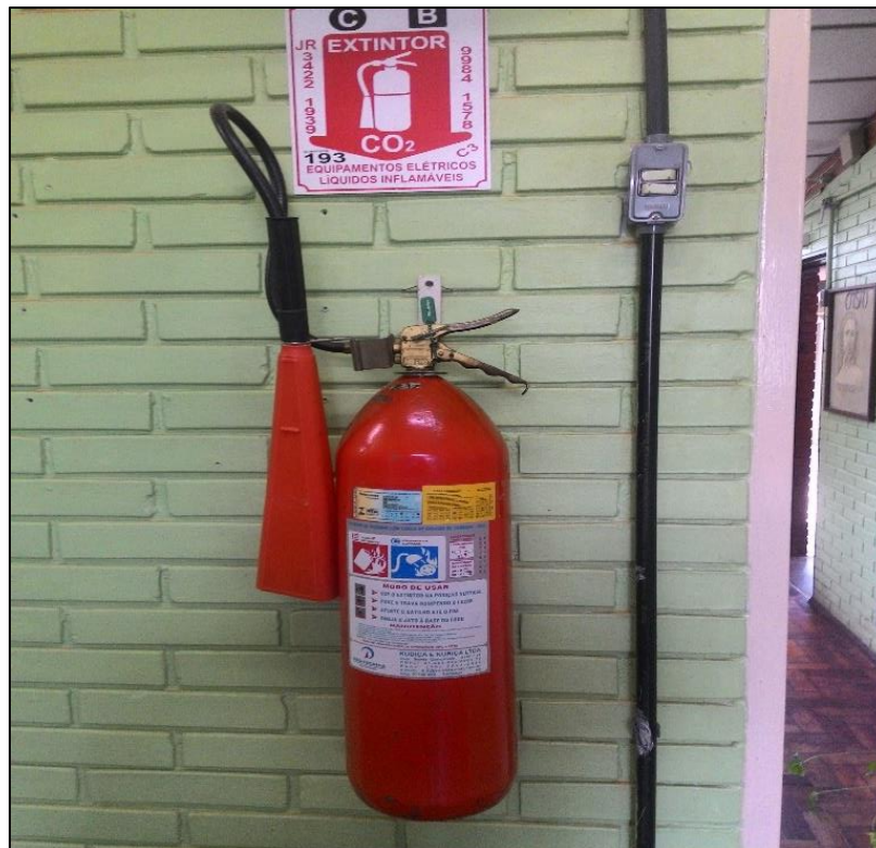
Figura 43 - Extintor BC / Bloco 1
