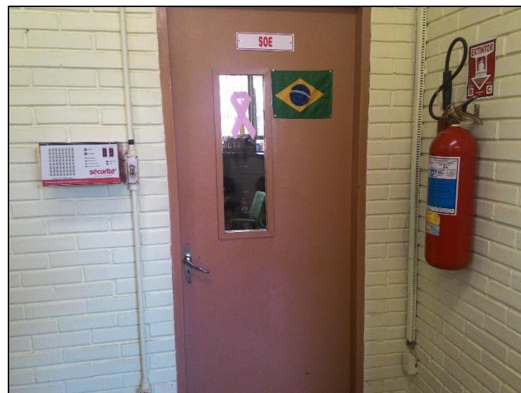
Figura 63- Central de controle do sistema / Bloco 1
