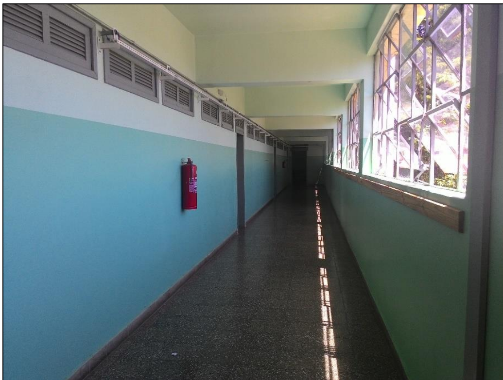
Figura 73 - Corredor sem sinalização / Bloco 1
