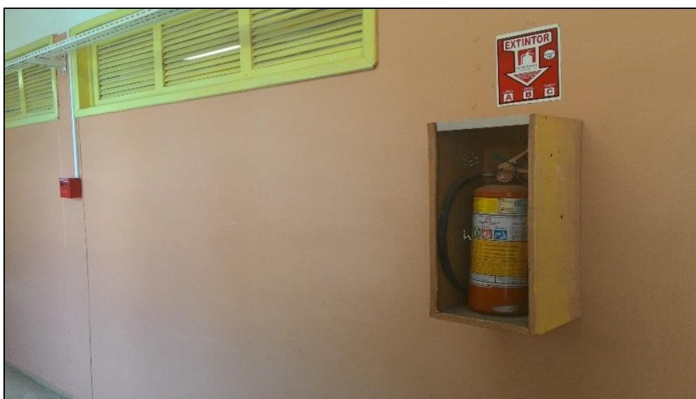
Figura 64 - Acionador manual de incêndio / Bloco 3
