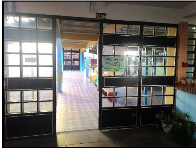
Figura 62 - Iluminação de Balizamento / Bloco 7
