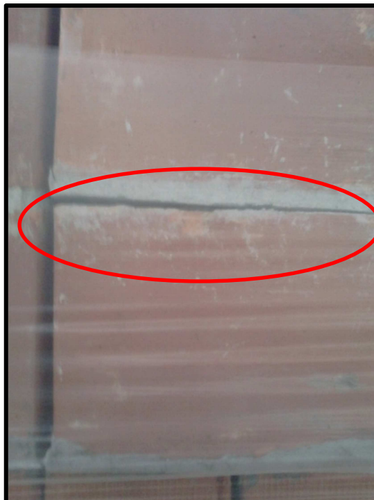
Figura 16 – Ruptura por esmagamento da junta no prisma com bloco de 10 MPa e argamassa de 10 MPa.
