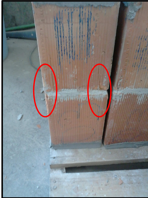
Figura 17 – Ruptura por fendilhamento do bloco no prisma com bloco de 7 MPa e argamassa de 4 MPa.
