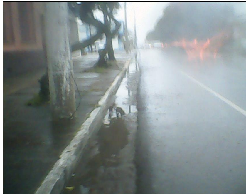
Figura 31 – Problemas de escoamento advindo do desnível pista/acostamento
