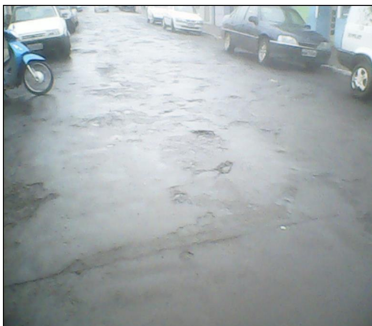
Figura 48 – Aspecto da Rua dos Andradas em um dia chuvoso
