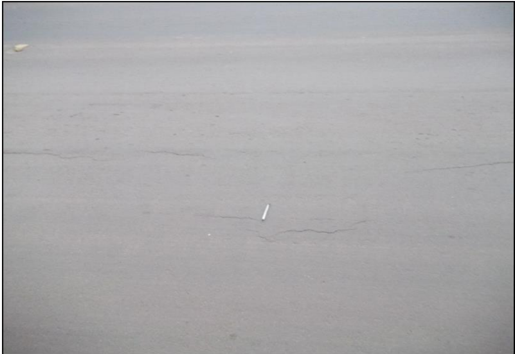
Figura 35 – Trincas isoladas encontradas na Av. Dr. Lauro Dornelles
