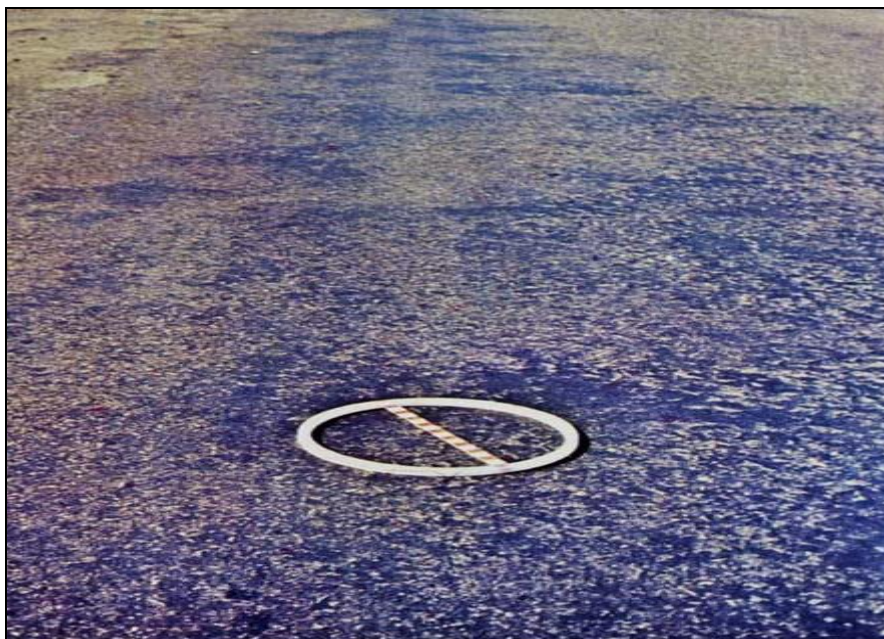
Figura 9 – Exsudação de asfalto
