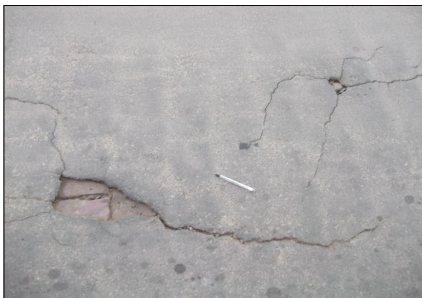
Figura 62 – Painela encontrada na Rua Bento Manoel
