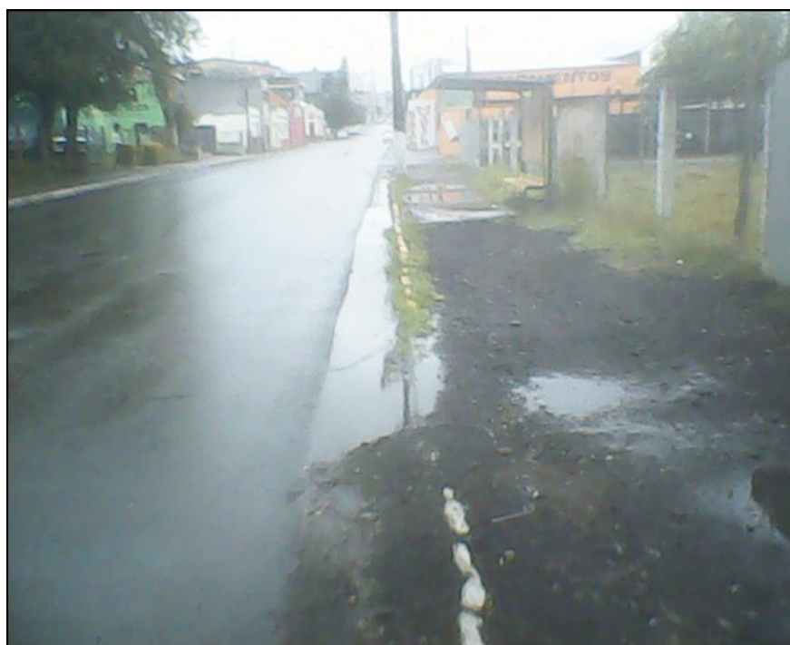
Figura 58 - Problemas relacionados ao desnível pista/acostamento
