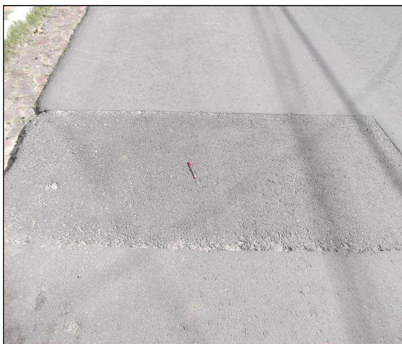
Figura 52 – Remendo encontrado na Rua Barão do Amazonas
