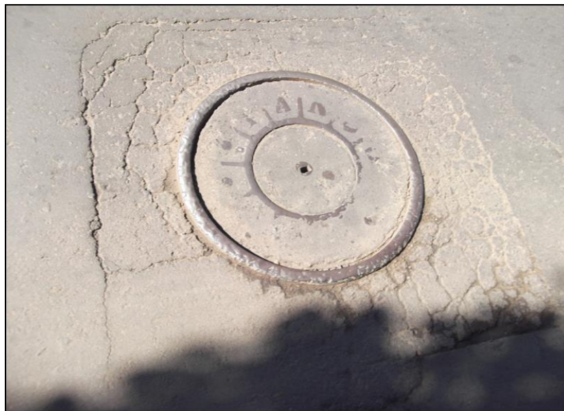
Figura 28 – Surgimento de trincas interligadas em torno do PV
