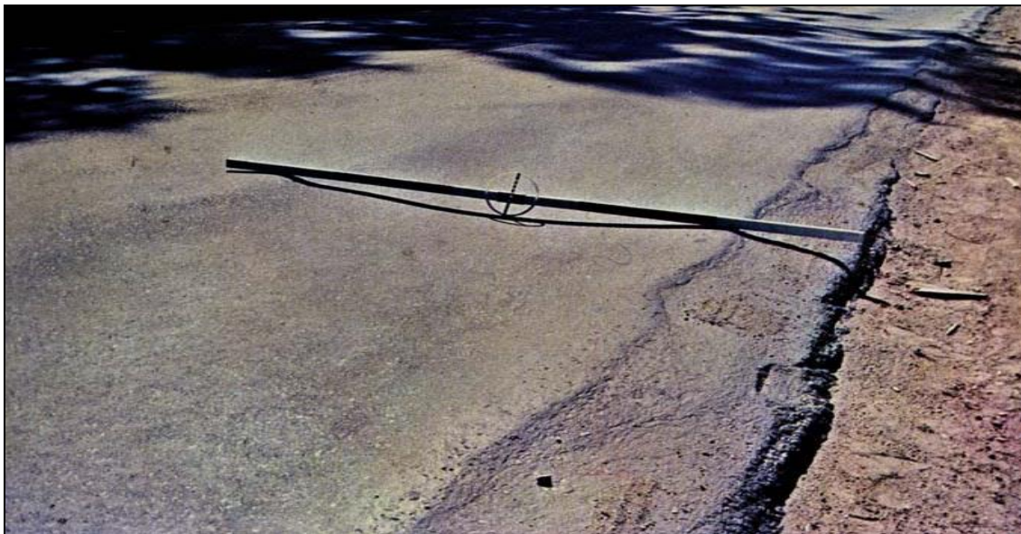
Figura 7 – Afundamento de trilha de roda
