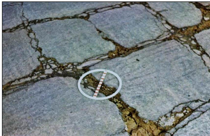
Figura 16 – Trinca Interligada Tipo Bloco
