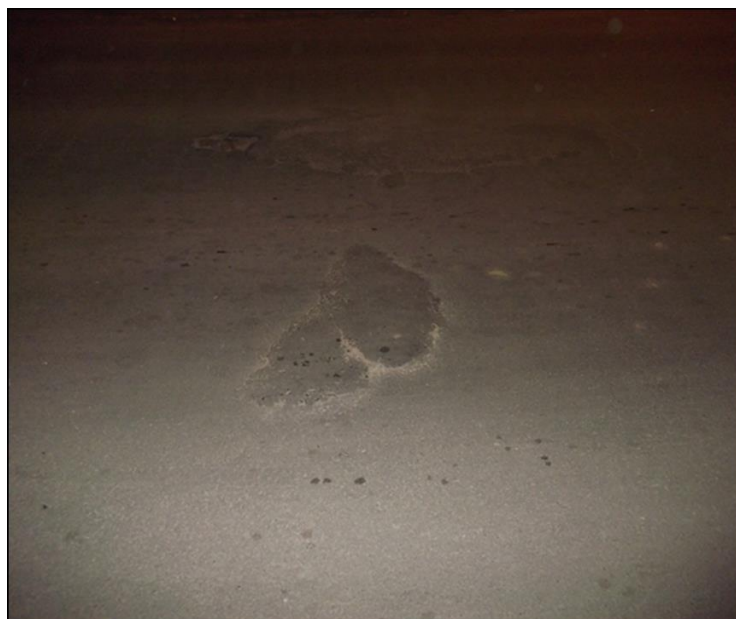
Figura 63 – Ondulação encontrada na Rua Bento Manoel
