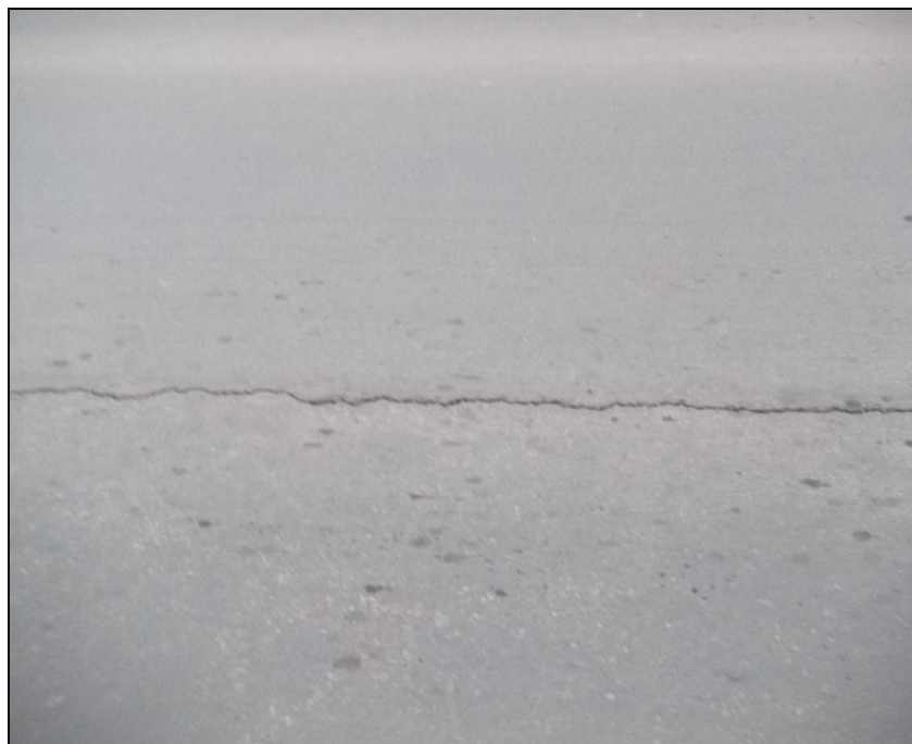
Figura 61 – Trinca Isolada encontrada na Rua Bento Manoel
