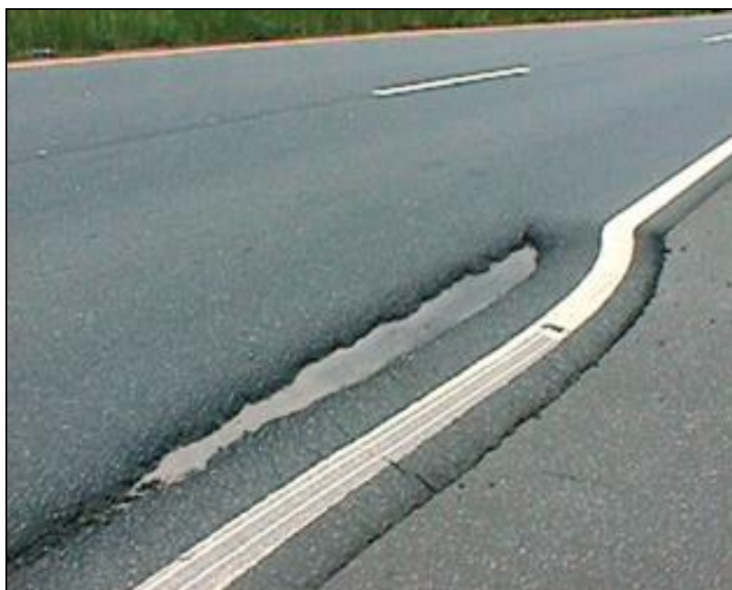
Figura 12 – Escorregamento de revestimento betuminoso
