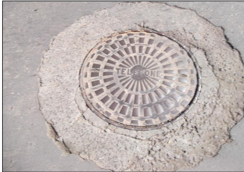
Figura 27 – Falta de acabamento em torno do PV
