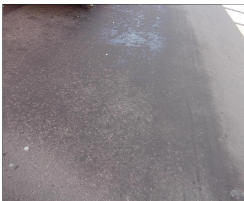
Figura 51 – Exsudação encontrada na Rua Barão do Amazonas
