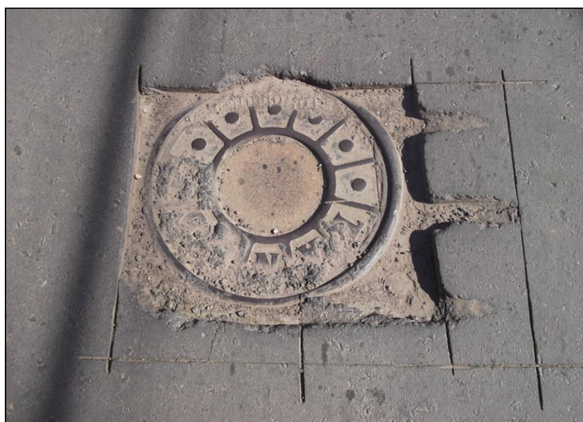
Figura 54 – Desnivelamento entre a tampa do PV e o pavimento asfáltico
