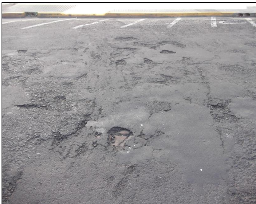
Figura 46 – Defeitos diversos encontrados na Rua dos Andradas
