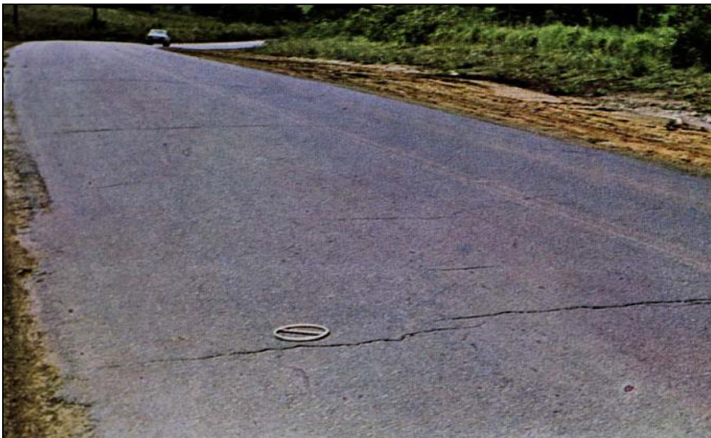
Figura 14 – Trinca Isolada Transversal
