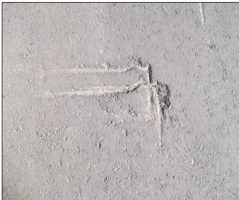
Figura 53 – Marcas de retroescavadeira no pavimento asfáltico
