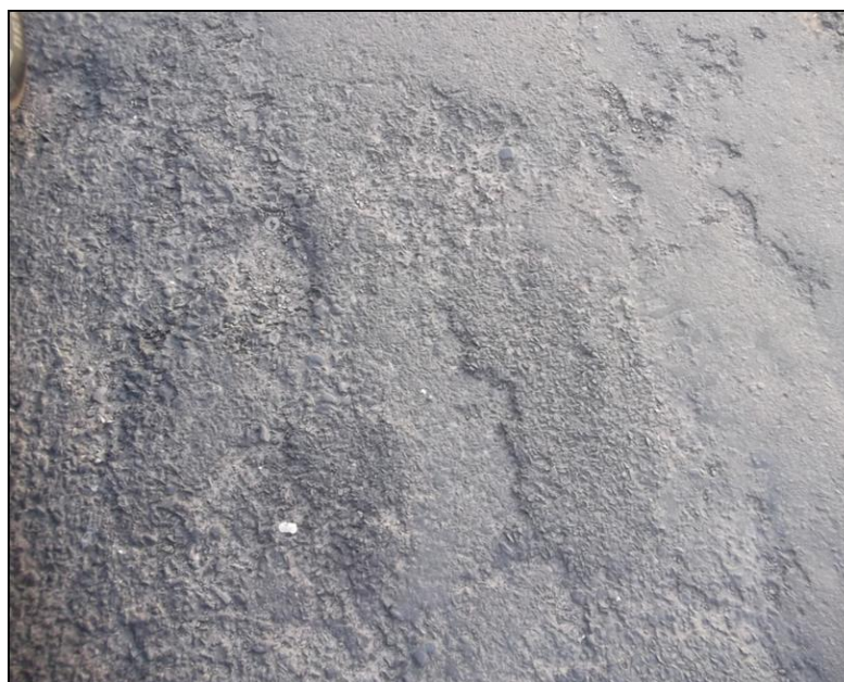
Figura 45 – Desgaste encontrado na Rua dos Andradas
