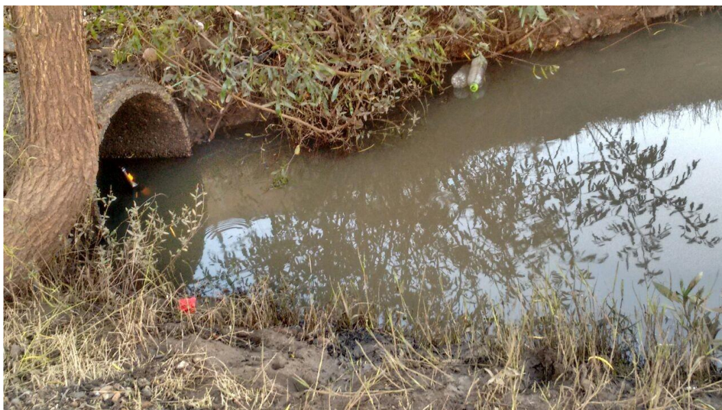
Figura 2. Esgoto não tratado no P1 (S' 29° 44'.987 e W' 057° 05.449).
