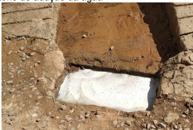
Figura 8 – Reservatório de adução da água
