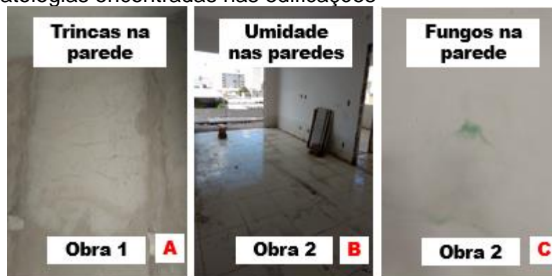
Figura 21 – Patologias encontradas nas edificações
