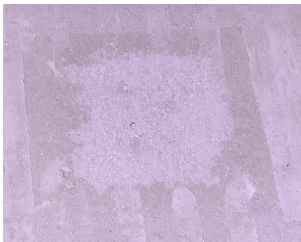
Figura 33: Ruptura na interface da argamassa e substrato (S/A)
