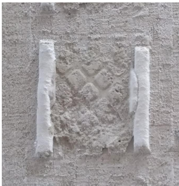
Figura 34: Ruptura na interface argamassa e placa cerâmica (A/P)
