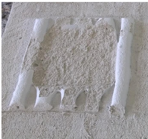
Figura 32: Ruptura na camada da argamassa colante (A)
