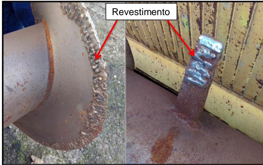
Figura 1 – Componentes com revestimento já desgastados do rotor axial.
