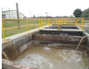
(d) Tratamento do Efluente
